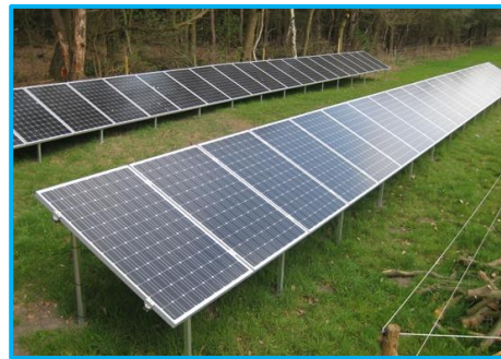
Afbeelding 2: Zonnepanelen in weide.
