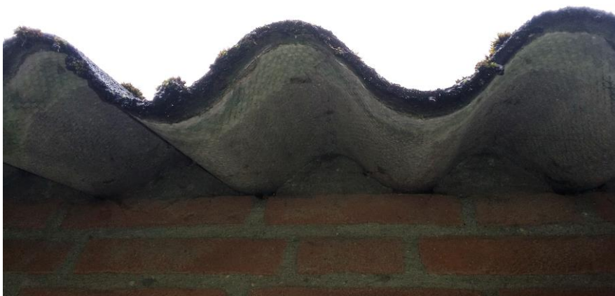
Figuur 12. De ruimte onder de ‘golven’ van het dak van het schuurtje is opgevuld met cement.
