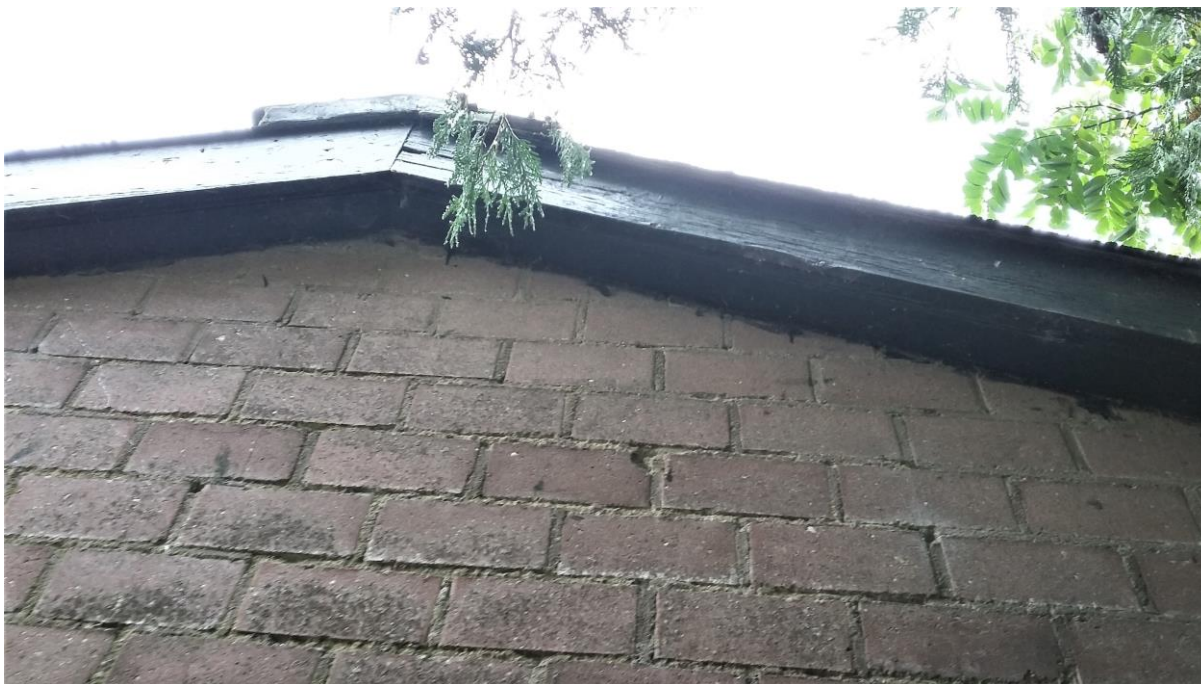
Figuur 18. Er zijn geen kieren tussen de boeiboorden van de voormalige koeienstal en de muur.
