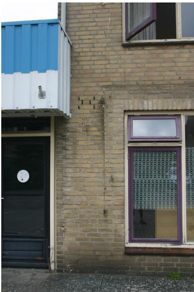
Figuur 5. Zes open stootvoegen in het woonhuis (linksboven het kleine raam).
