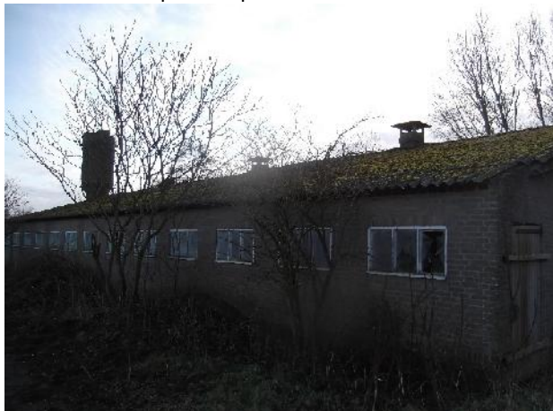
Foto 1: Golfplaten op dak stal
