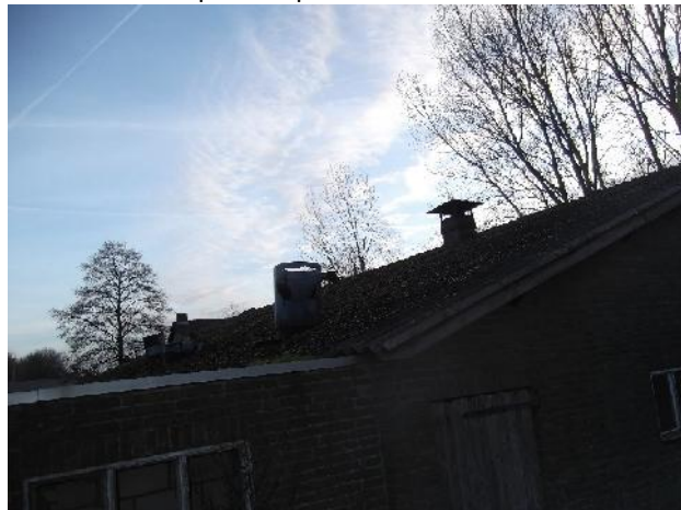
Foto 2: Golfplaten op dak stal
