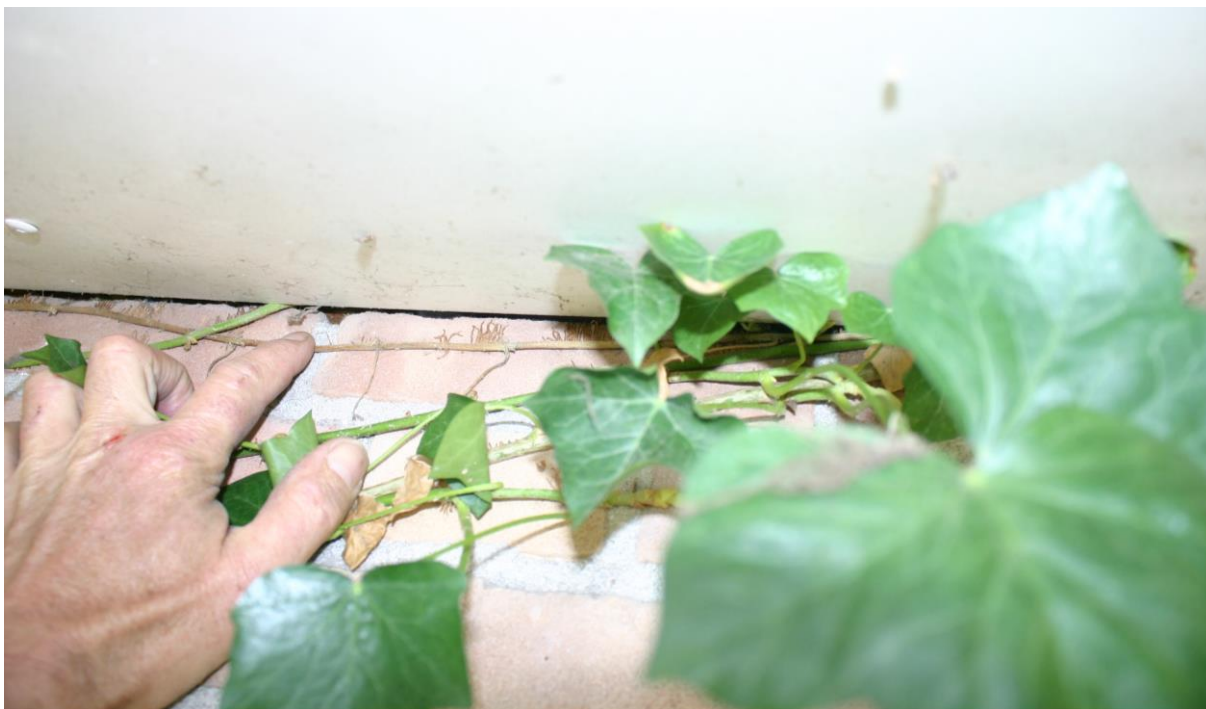
Figuur 4.2.1. De dakoverstek sluit niet overal nauw aan.
