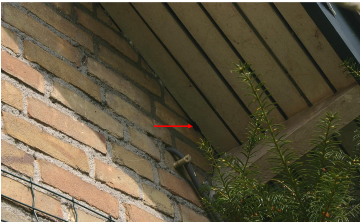
Figuur 4.2.2. Op enkele plekken kiert de dakoverstek (rode pijl).
