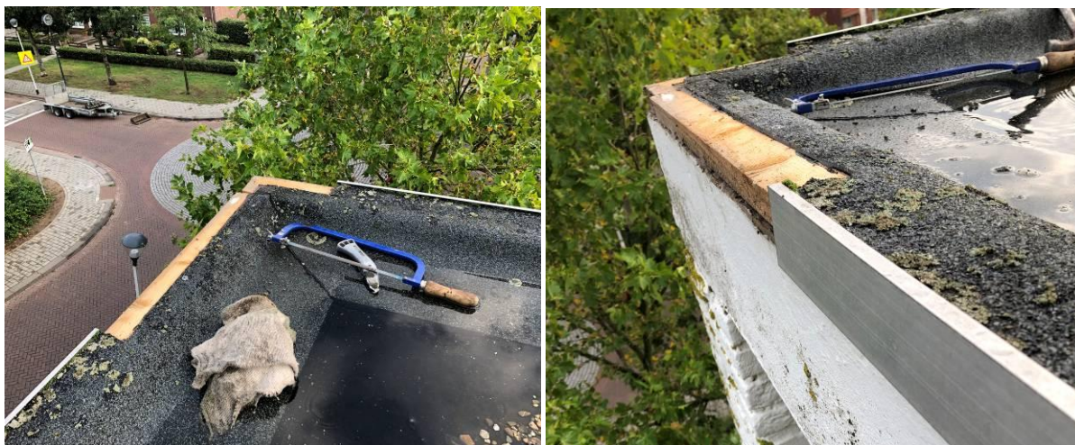
Foto's: verwijderde daktrim op beide hoekpunten voorzijde: geen sporen van vleermuizen
