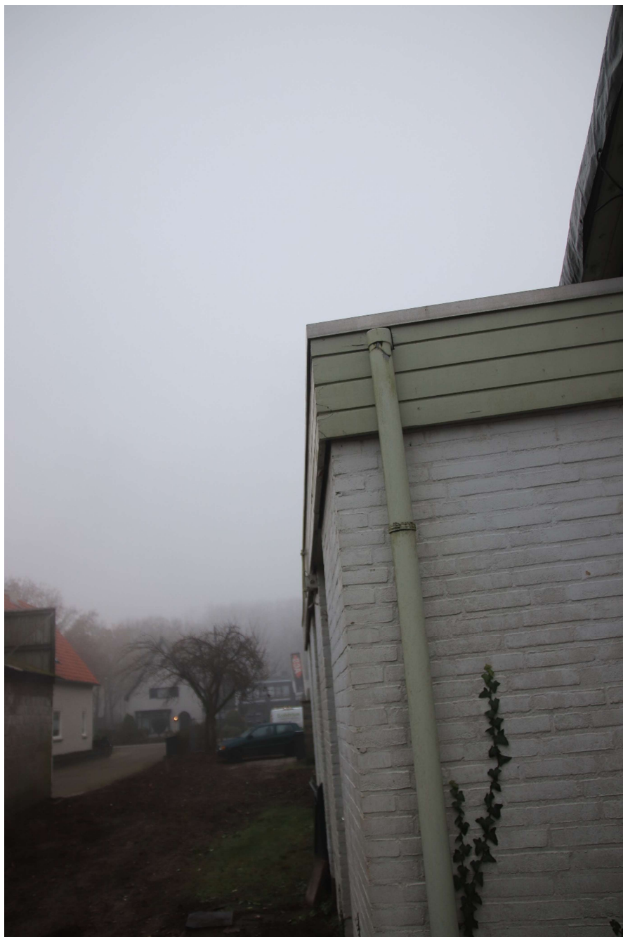
Foto 3: er zijn geen openingen in de bekisting voor vleermuizen
