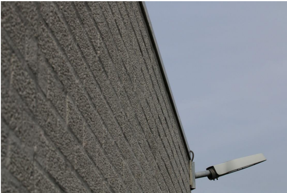
Figuur 19. De daktrim sluit overal goed aan en fungeert als sierlijst. Onder de daktrim is geen opening aanwezig die toegang geeft tot de spouw.
