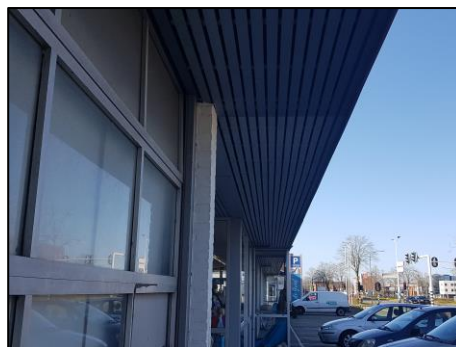
Figuur 12. Spleten tussen latten onder daklijst waar vleermuizen gebruik van kunnen maken.
