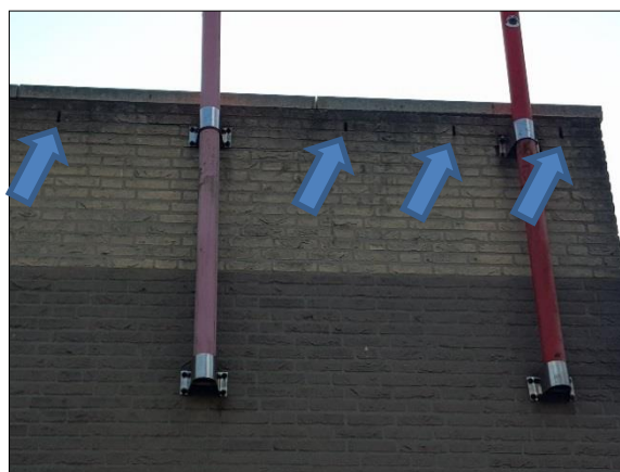
Figuur 12. Open stootvoegen in deels te slopen gebouw
