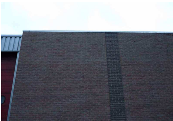
Fig 7. Er zijn meerdere open stootvoegen in de hal aan de noordkant van het plangebied. Foto genomen in zuidelijke richting.
