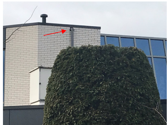
Afbeelding 7. Detail van het kantoor, met bij de regenpijp mogelijke ingangen voor vleermuizen (rode pijl).
