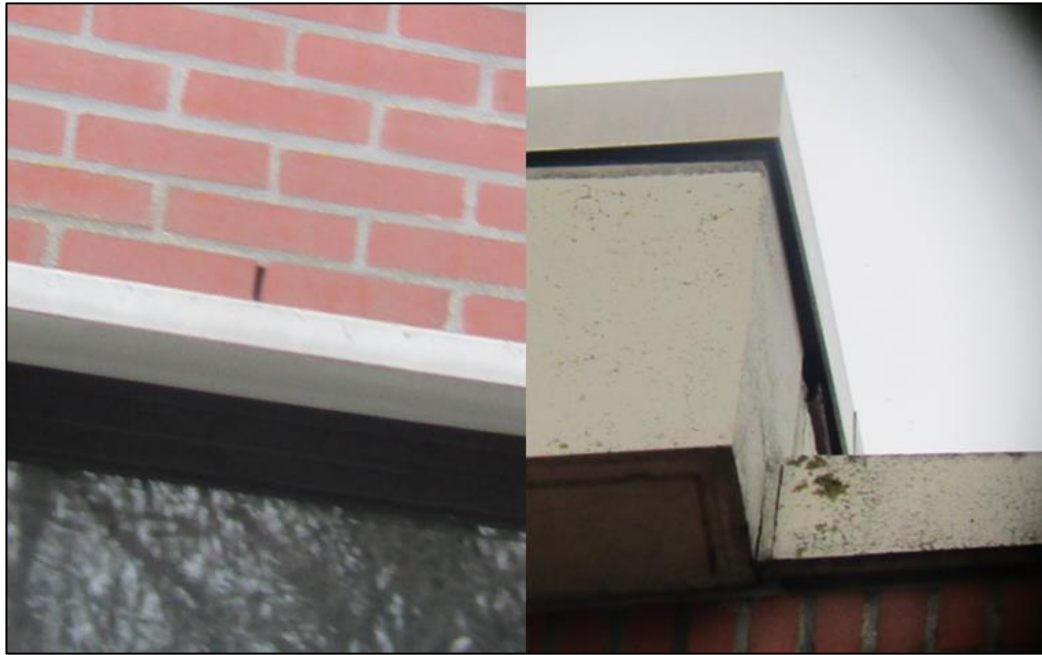
Figuur 1.3 Middels kierende daklijsten en open stootvoegen kunnen vleermuizen toegang krijgen tot binnenruimtes waardoor potentie voor vorengenoemde soorten niet uitgesloten kan worden. Het betreffen kleine openingen, waardoor de grotere soorten als laatvlieger uitgesloten kunnen worden (Fairhurst, 2020).
