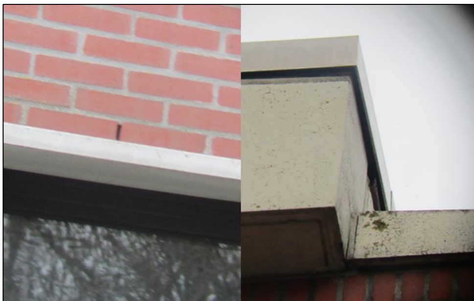
Figuur 3 Open stootvoegen en kierende daklijsten bieden toegang tot de open spouwmuur.
