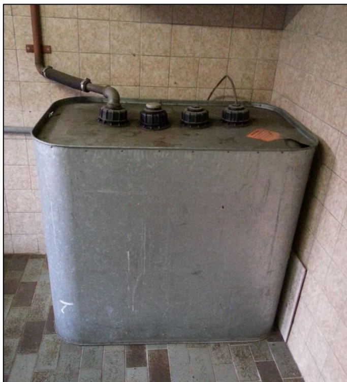
Afbeelding 3: Foto bovengrondse tank in pandig gebouw (bron: Opdrachtgever)
