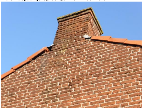
Veel kieren en holtes, ook onder dakpannen.
