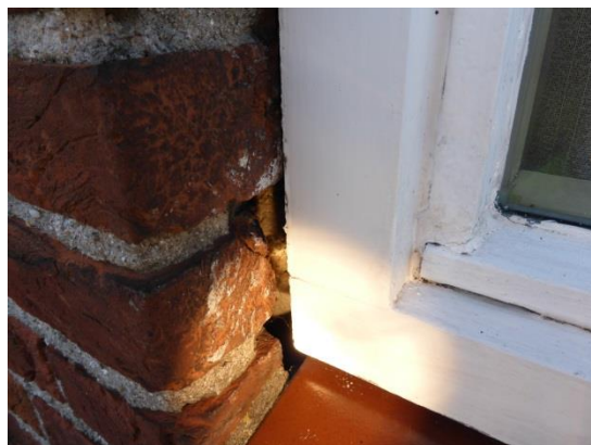
Gat muur, open toegankelijk spouwmuur zichtbaar, woonhuis.
