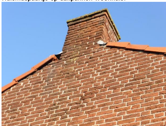
Veel kieren en holtes, ook onder dakpannen.
