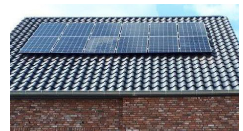
zonnepanelen en dakramen geïntegreerd in dakvlak
