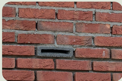
Spouwmuur geschikt maken - invliegopening gevel
