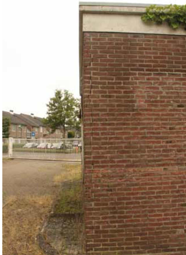
1. Scheurvorming op hoeken.
