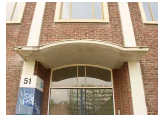
2. Detail luifeldak met betonschade.
