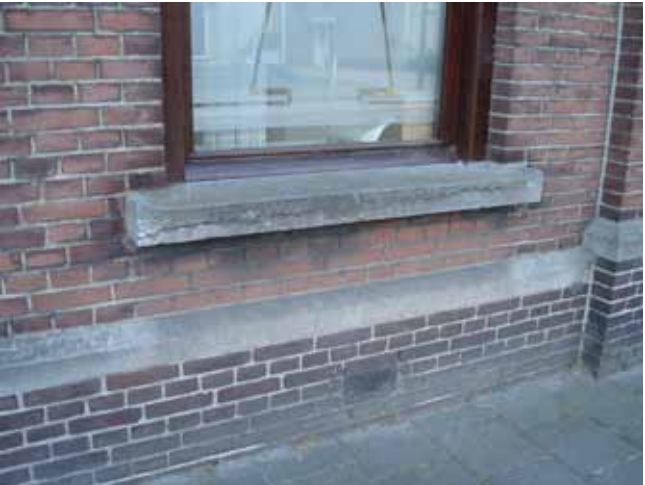
IX. Brandlaag in hardstenen waterslag en beginnende roestvorming rond kruipruimte ventilatierooster.
