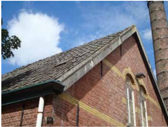
I. Mogelijk asbest windveer, voegwerk geërodeerd, schilderwerk verweerd.
