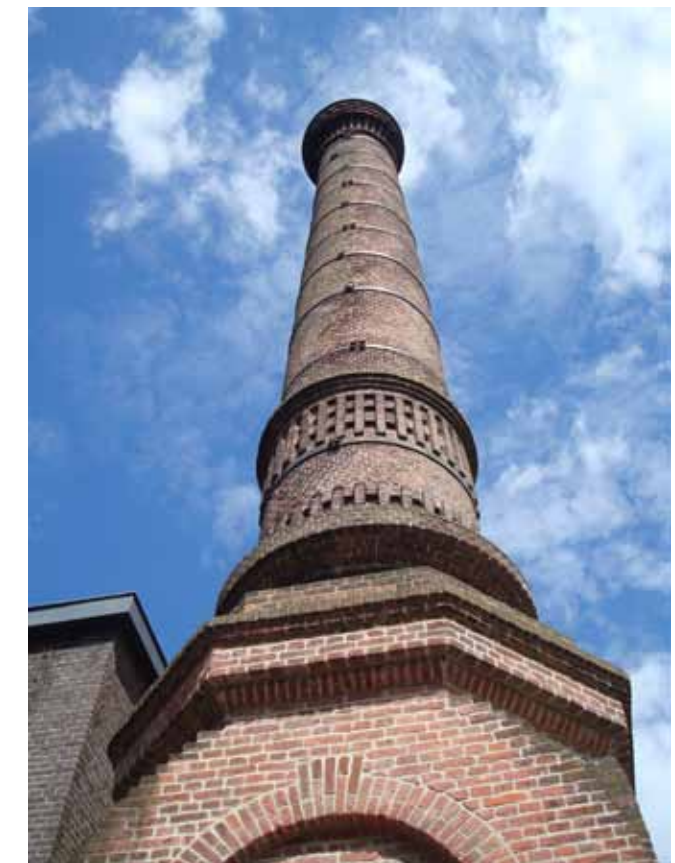
III. Metselwerk is goed, hogerop aangetast door eroderend voegwerk.
