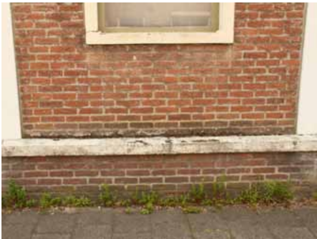
3. Plintlijst met vochtschade.
