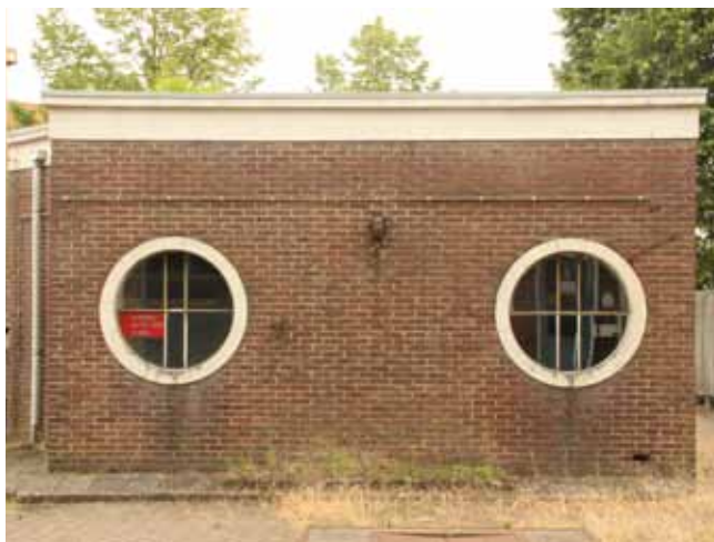
1. Gevel in redelijke staat, beton van raamopeningen en vensters. De hoeken zijn verticaal gescheurd.
