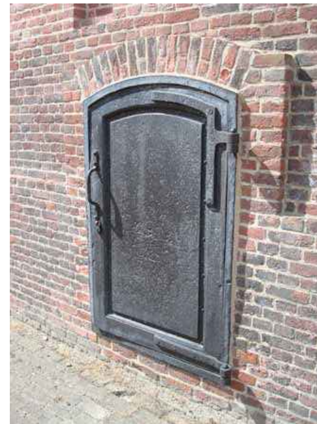
III. Veegluik in relatief recent gerestaureerd metselwerk.
