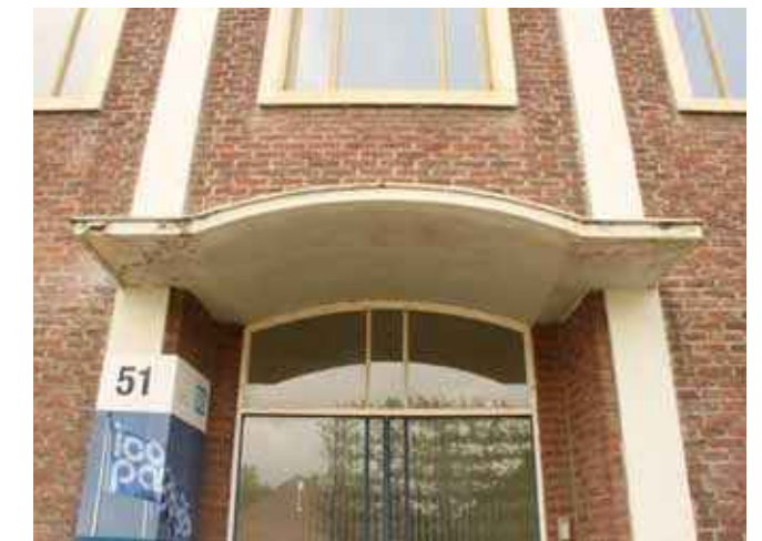
2. Detail luifeldak met betonschade.
