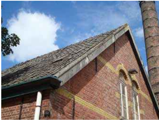
I. Mogelijk asbest windveer, voegwerk geërodeerd, schilderwerk verveerd.
