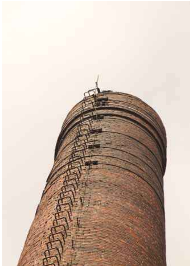
14. De schoorsteenkop vertoont loszittend voegwerk en gescheurde stenen, de klimijzers vragen een nadere inspectie.
