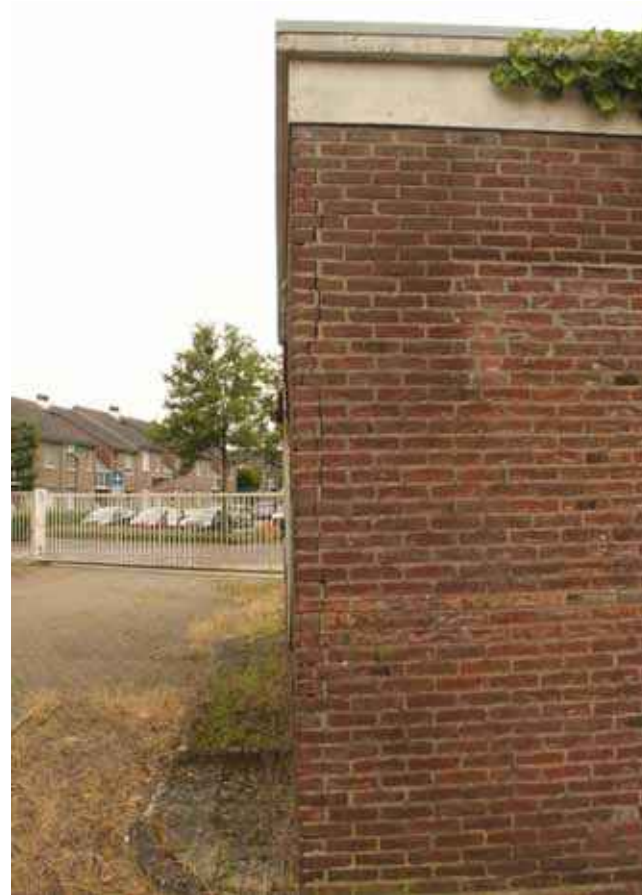
1. Scheurvorming op hoeken.
