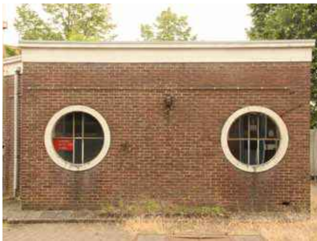
1. Gevel in redelijke staat, beton van raamopeningen en vensters. De hoeken zijn verticaal gescheurd.
