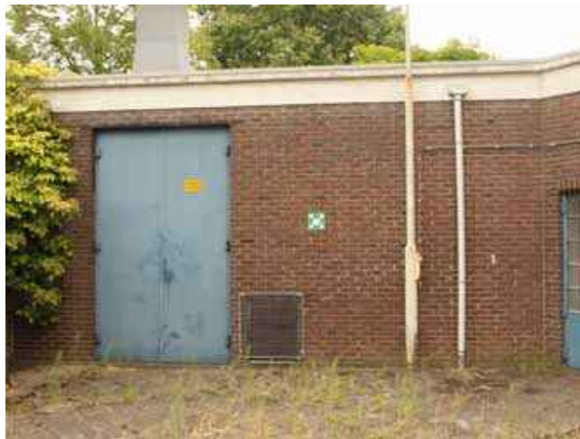
1. Voorgevel in redelijke staat maar verticaal gescheurd.
