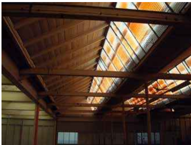
VI. Niet afgetimmerde sheddakconstructie.
