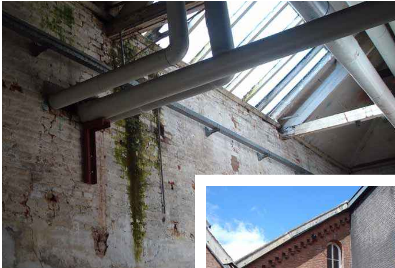
IV. Lekkage onder legzaam.
