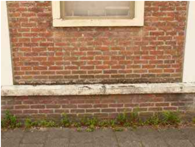
3. Plintlijst met vochtschade.
