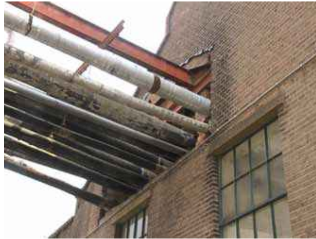
15. Vervolgschade van de doorgevoerde installaties door de gevel.
