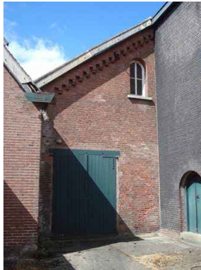
IV. Voorgevel met rechtsonder aangetast metselwerk en scheur boven deur. Mogelijk asbesthoudende windveer.
