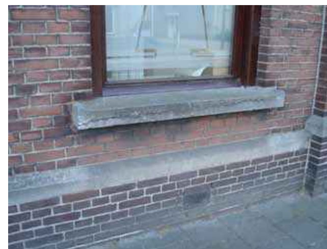
IX. Brandlaag in hardstenen waterslag en beginnende roestvorming rond kruipruimte ventilatierooster.
