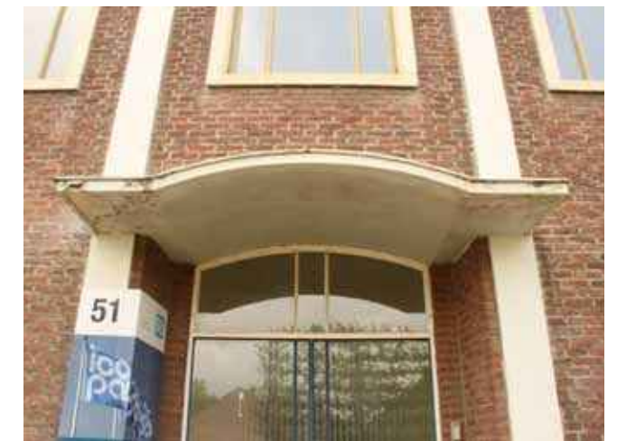
2. Detail luifeldak met betonschade.
