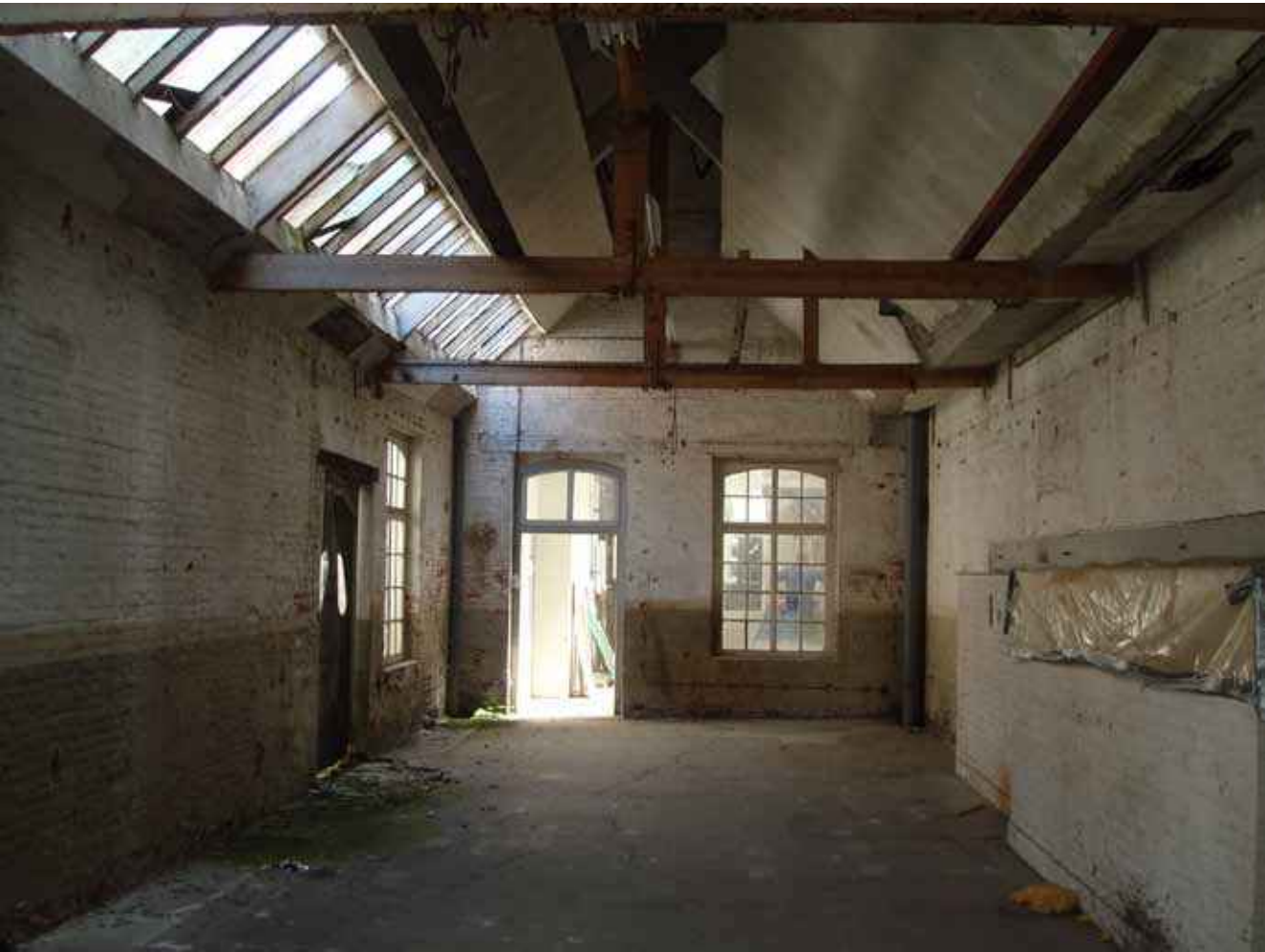
II. Metselwerk en houtwerk goed, respectievelijk redelijk. Leksporen onder goot en rond kapvoet doen aantasting kapconstructie vermoeden.
