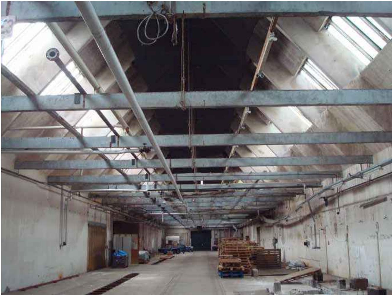
XIX. Kapconstructie is aan het zicht onttrokken. Sporen van grootschalige langdurige lekkage ontbreken.
