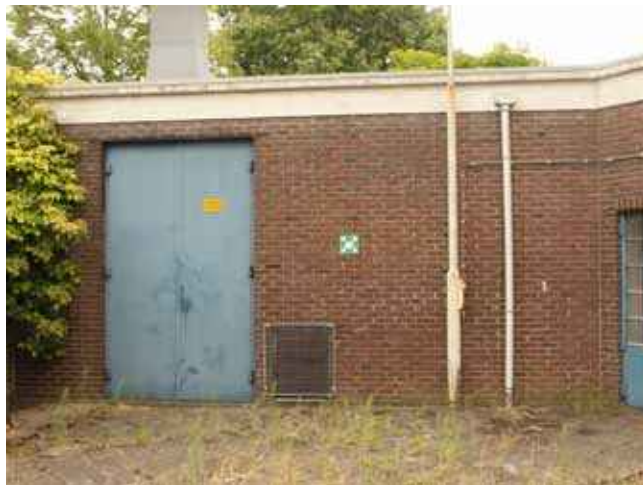
1. Voorgevel in redelijke staat maar verticaal gescheurd.
