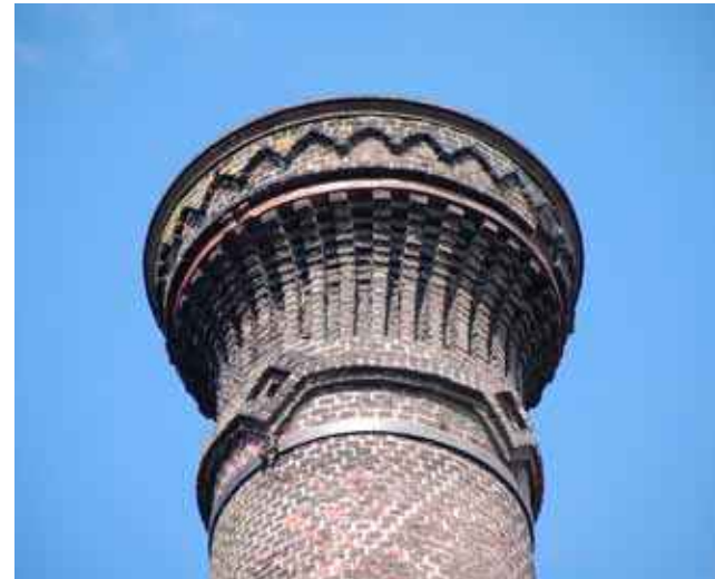
III. Metselwerk hogerop aangetast door eroderend voegwerk.
