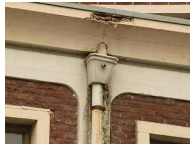
2. Detail betonnen dakrand - het metselwerk en dekstuk is langdurig vochtbelast door een slechte afwatering, dit zal vervolgschade opgeleverd hebben.
