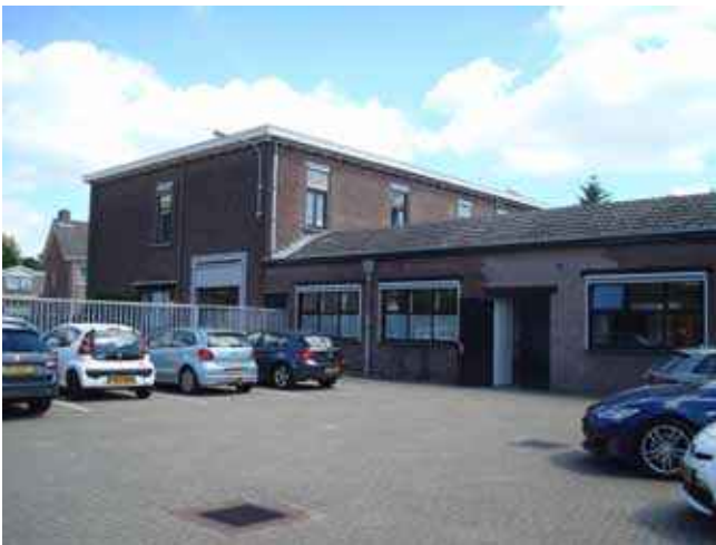
XIV. Voorgevel met detonerende reparatie waar oorspronkelijk een brede deur heeft gezeten.
