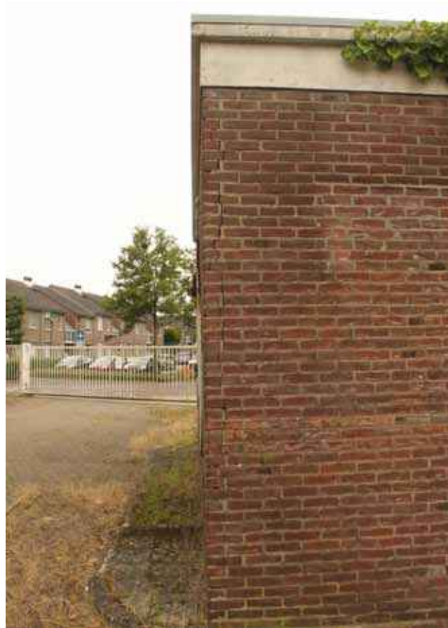
1. Scheurvorming op hoeken.
