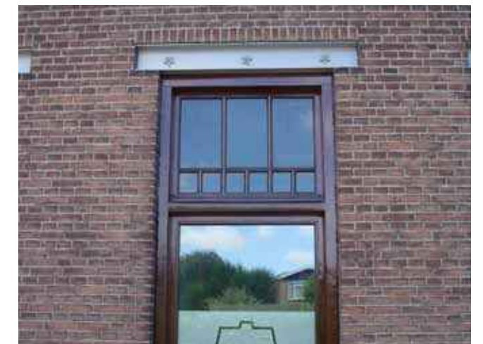
IX. Venster met mogelijk beginnende roestvorming in linker oplegging van de latei.
