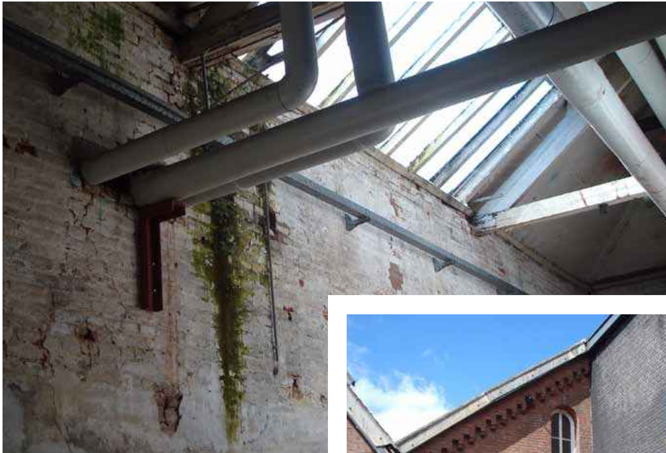
IV. Lekkage onder legraam.
