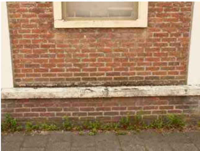
3. Plintlijst met vochtschade.
