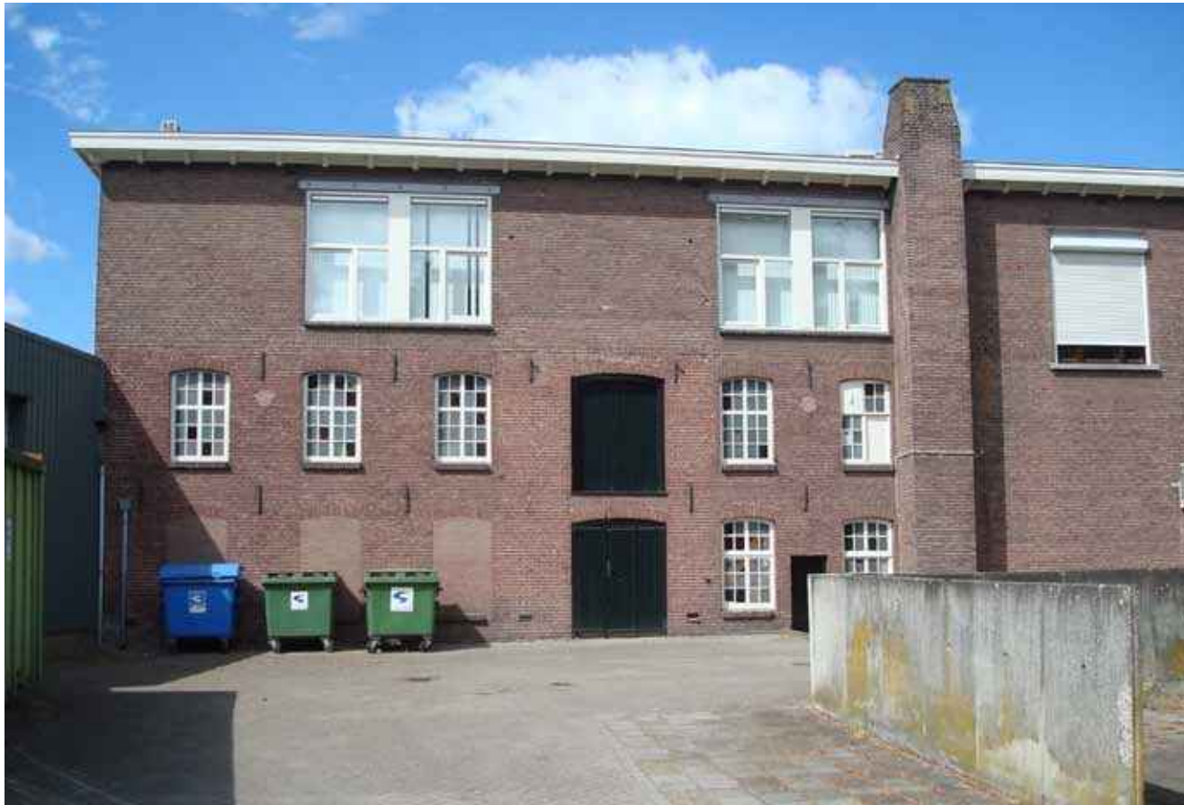
VIII. Gevelmetselwerk is in goede staat, hier en daar geërodeerd voegwerk, (vrijwel) geen roestvorming bij lateien, roosters en ankers.
