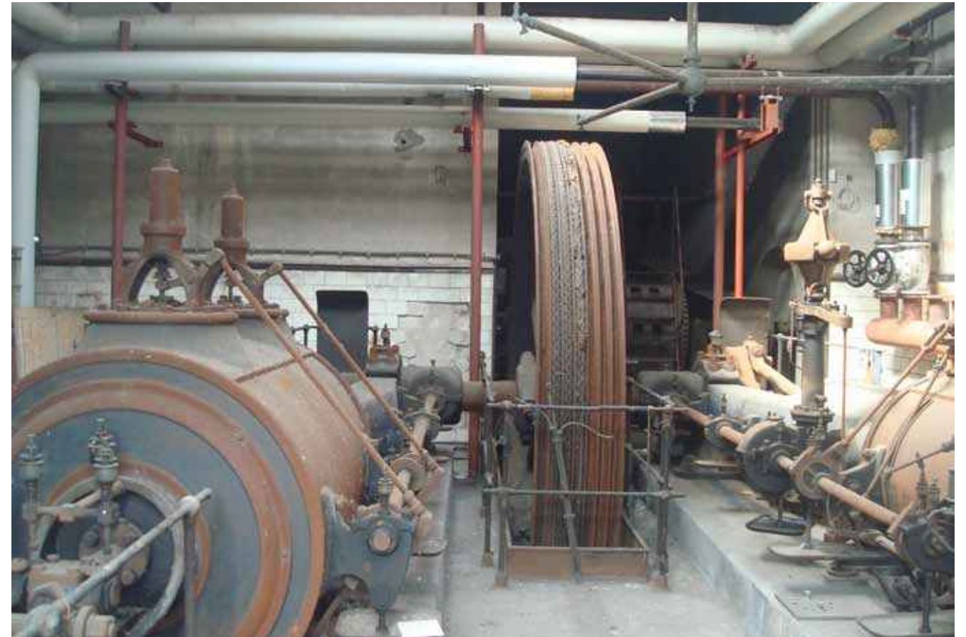
V. Interieur Machinekamer.
