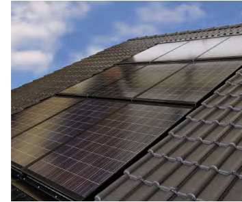
zonnepanelen geïntegreerd in dakvlak
