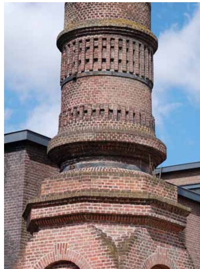
III. Metselwerk is goed, hogerop aangetast door eroderend voegwerk.
