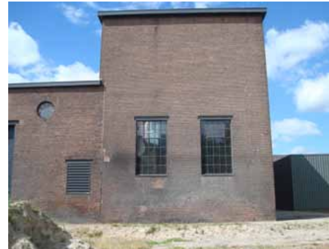
XXI. Metsel-, staal- en schilderwerk is in goede staat. Ontsierende reparatie aan de linkerzijde.
