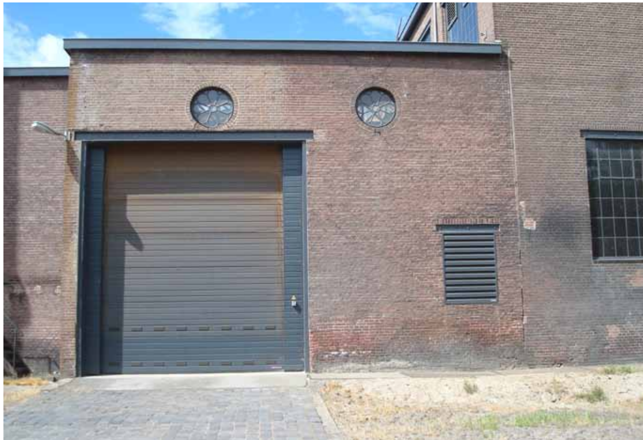
XX. Linksboven de latei is de gevel gescheurd. De plint is aangetast door (strooi)zout nabij de doorgang.
