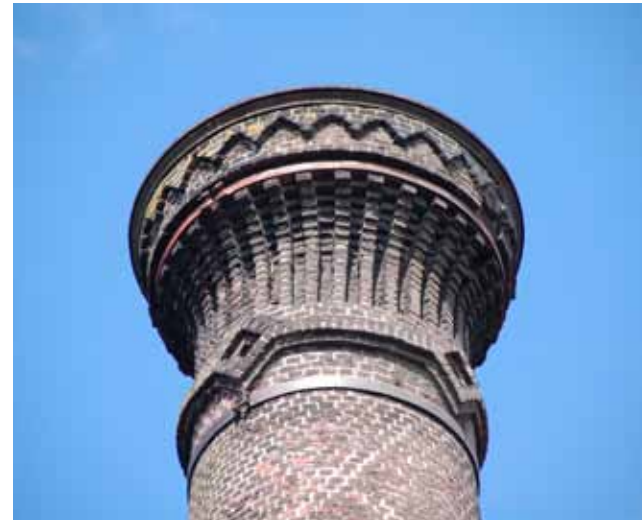
III. Metselwerk hogerop aangetast door eroderend voegwerk.
