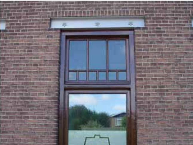
IX. Venster met mogelijk beginnende roestvorming in linker oplegging van de latei.
