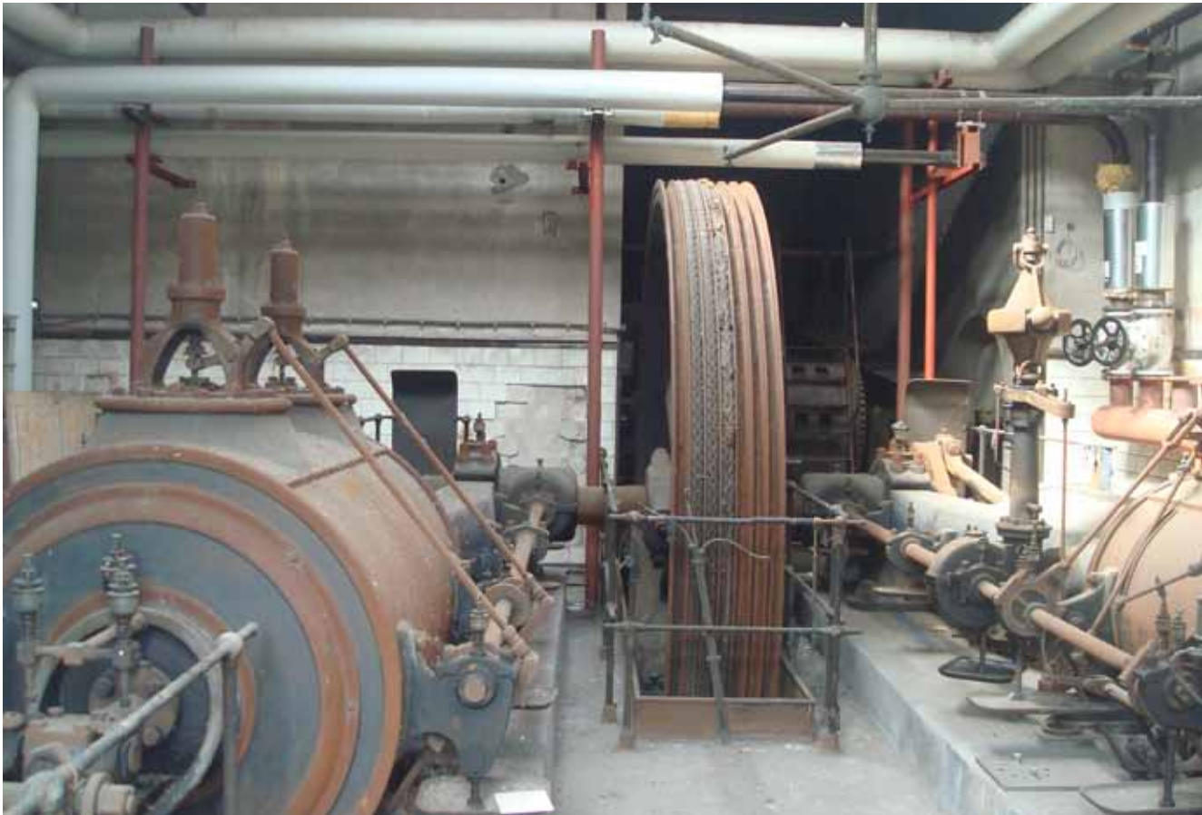
V. Interieur Machinekamer.
