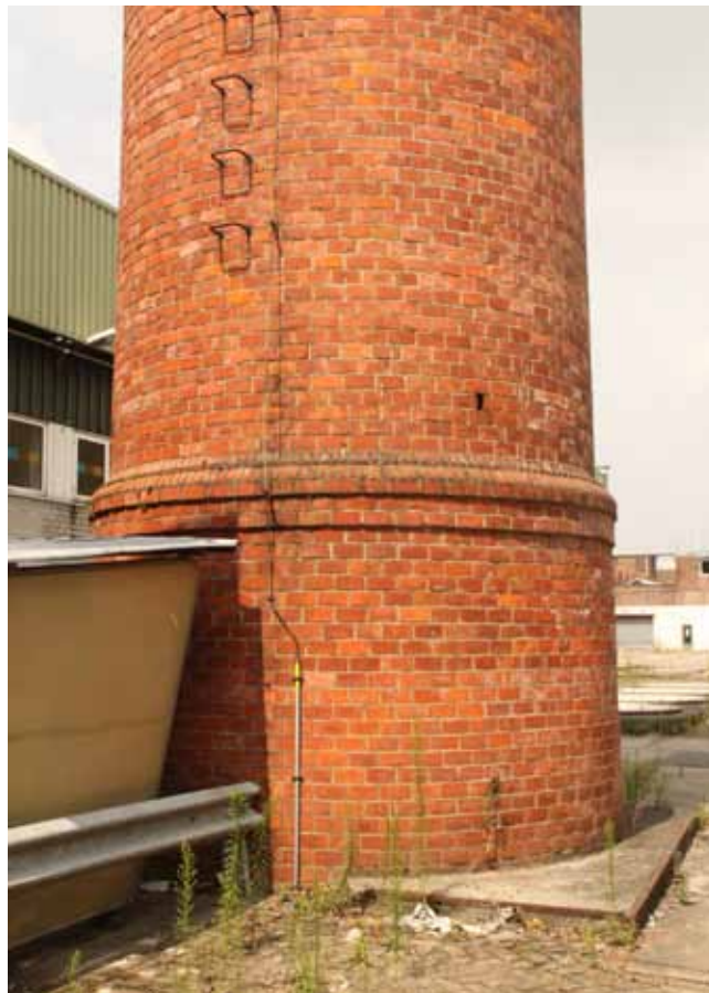
14. Metselwerk goed, hogerop aangetast door eroderend voegwerk.
