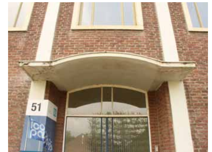
2. Detail luifeldak met betonschade.
