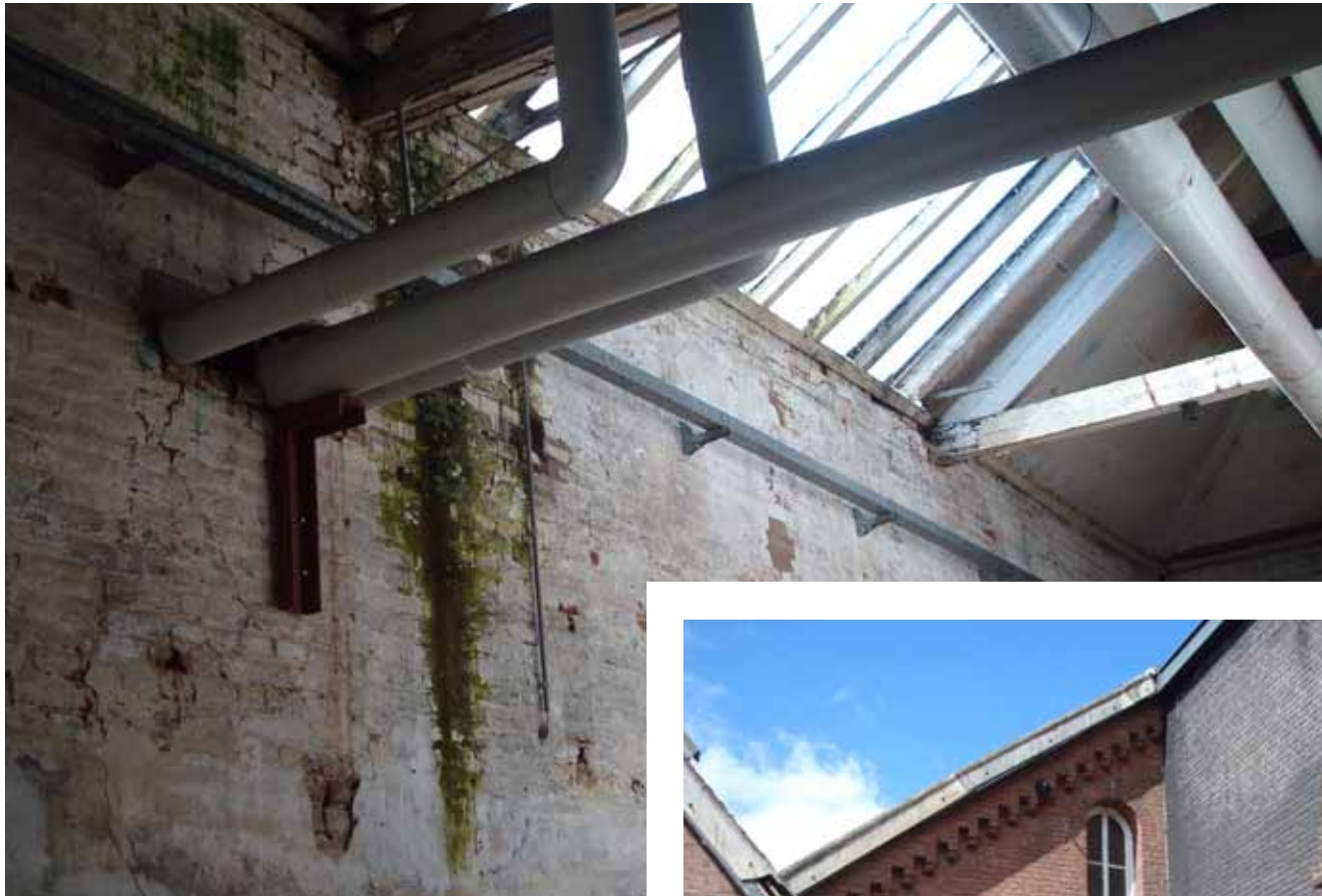
IV. Lekkage onder legzaam.
