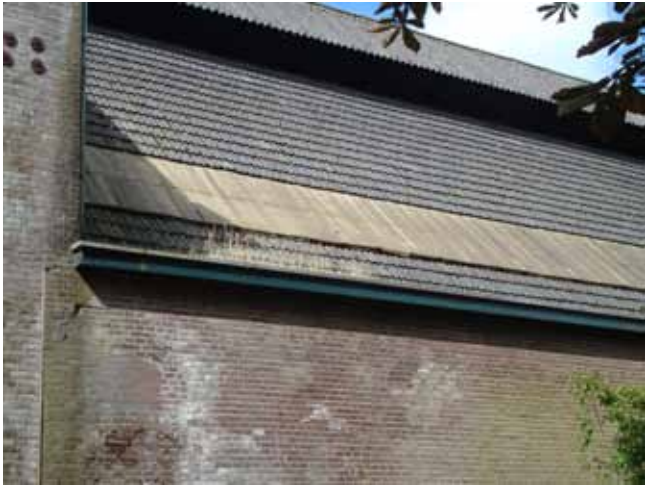
XIX. Zetting doordat de gevel van het aangebouwde volume op de topgevel rust. Erosie van metselwerk door verstopte goot.
