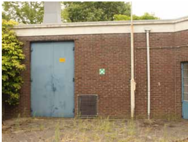
1. Voorgevel in redelijke staat maar verticaal gescheurd.
