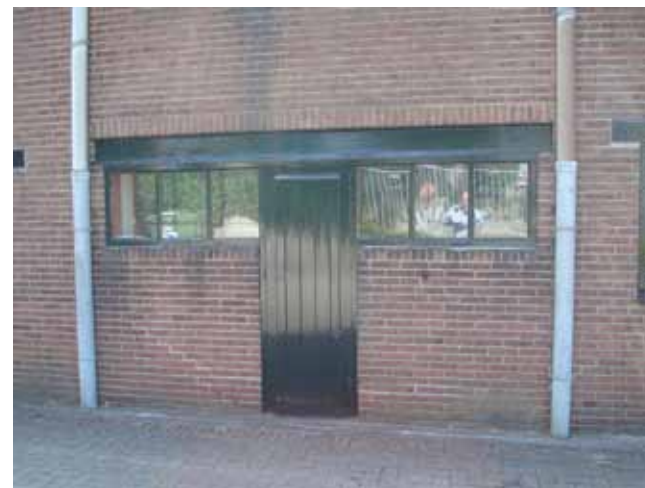
VI. Lichte zakking met daardoor gescheurd metselwerk ter weerszijde van de deur.
