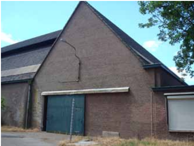
XVIII. Gevelmetselwerk plaatselijk geërodeerd boven maaiveld en ten gevolge van een langdurig lekkende hemelwaterafvoer.
