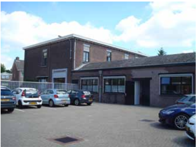
XIV. Voorgevel met detonerende reparatie waar oorspronkelijk een brede deur heeft gezeten.
