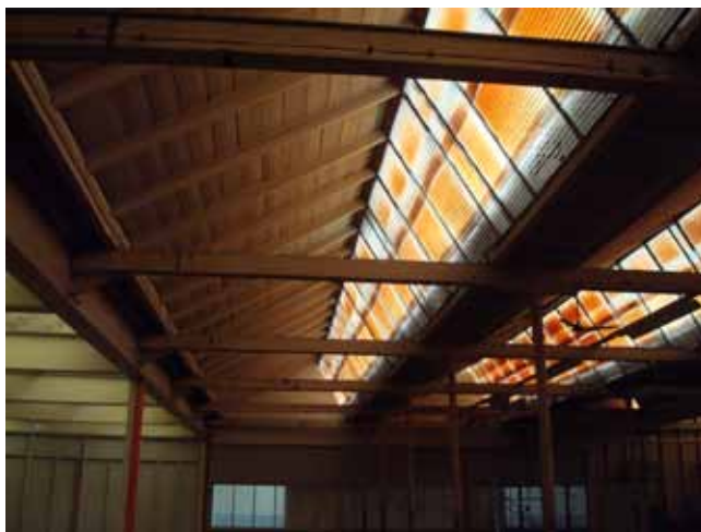
VI. Niet afgetimmerde sheddakconstructie.
