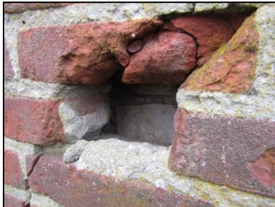
Figuur 9. Spouwmuur met openingen aanwezig.
