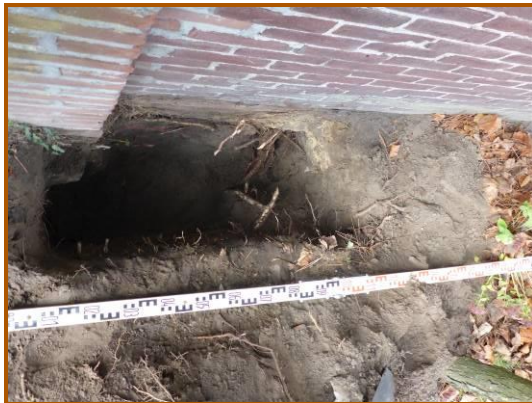
Afbeelding 6: Inzichtelijk maken van wortels onder de fundering
