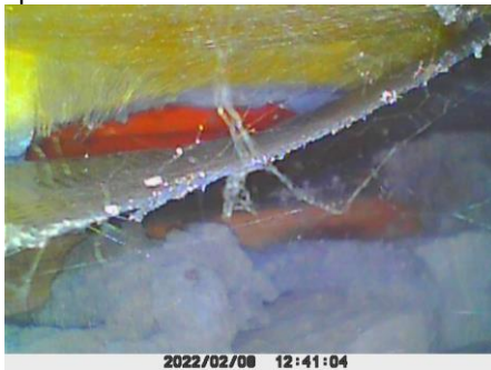
spouw DPC folie niet verdacht
