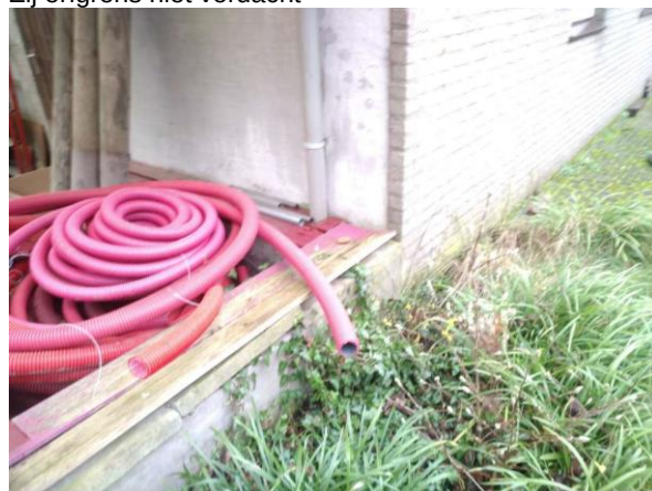
Riool PVC niet verdacht
