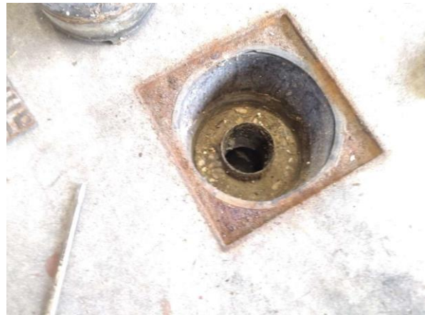
Schroput PVC niet verdacht
