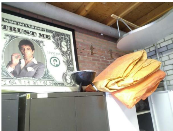
Opleg balken niet verdacht
