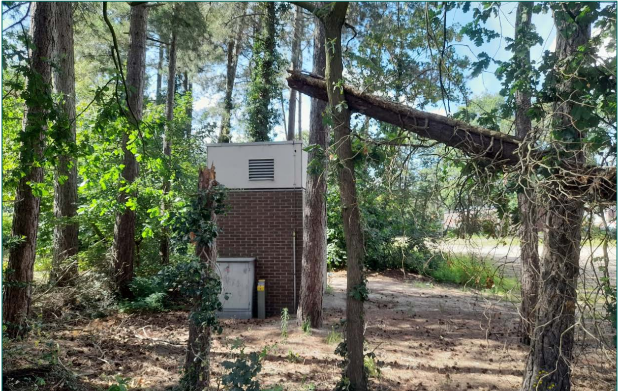
Figuur 13. Meest zuidelijke transformatorhuisje.
