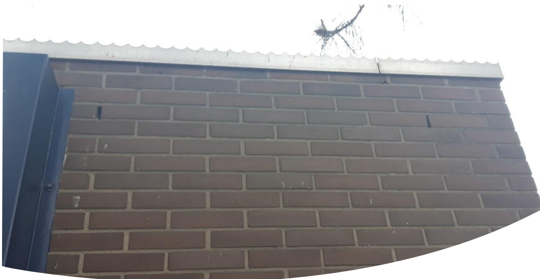
Afbeelding 3.4. Impressie aanwezige open stootvoegen die veelal spinnenrag bevatten.
