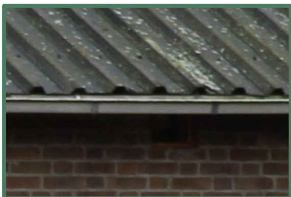
Foto 37: Damwand dak schuur (8).
