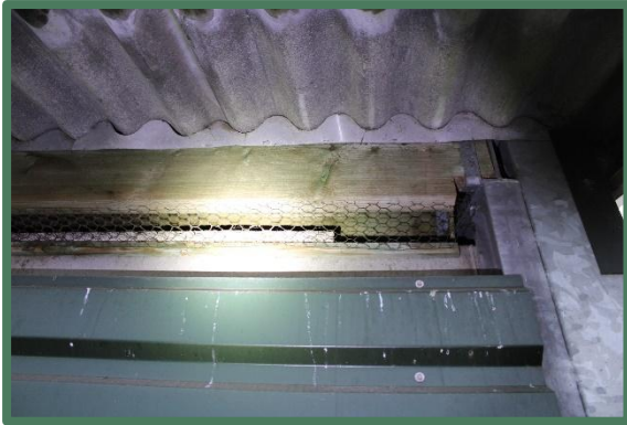
Foto 27: Luchtinlaat en dak voorzien van vogelgaas.
