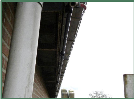
Foto 31: Luchtinlaat voorzien van vogelgaas.
