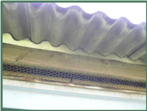
Foto 29: Luchtinlaat en dak voorzien van vogelgaas.
