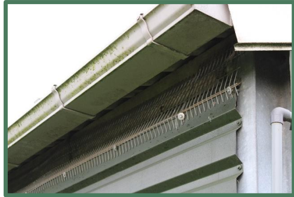
Foto 28: Luchtinlaat voorzien van vogelgaas.
