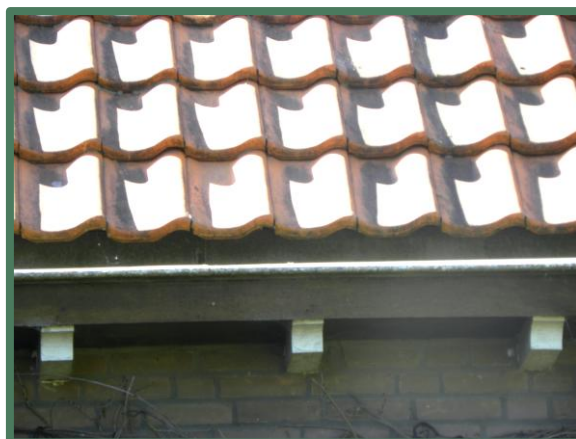
Foto 28: Ruimte onder de dakpannen van de woning volledig gesloten.
