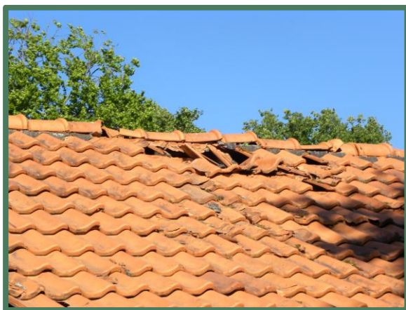
Foto 25: Dak van de schuur vervallen, losse pannen.
