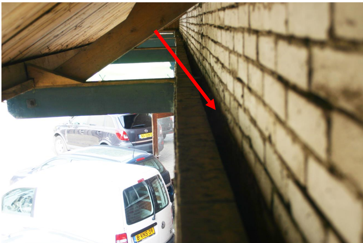
Figuur. 4.5.3. De spouw van de rechtergevel van de autostalling op nr. 30 is van boven open (rode pijl).
