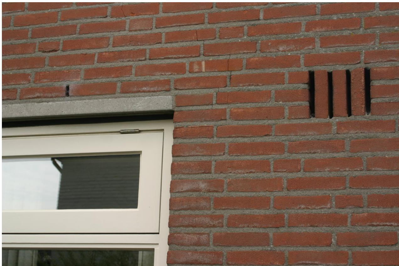
Figuur 4.5.1. Geïnspecteerde open stootvoeg en ventilatieopeningen van het woonhuis op nr. 26.
