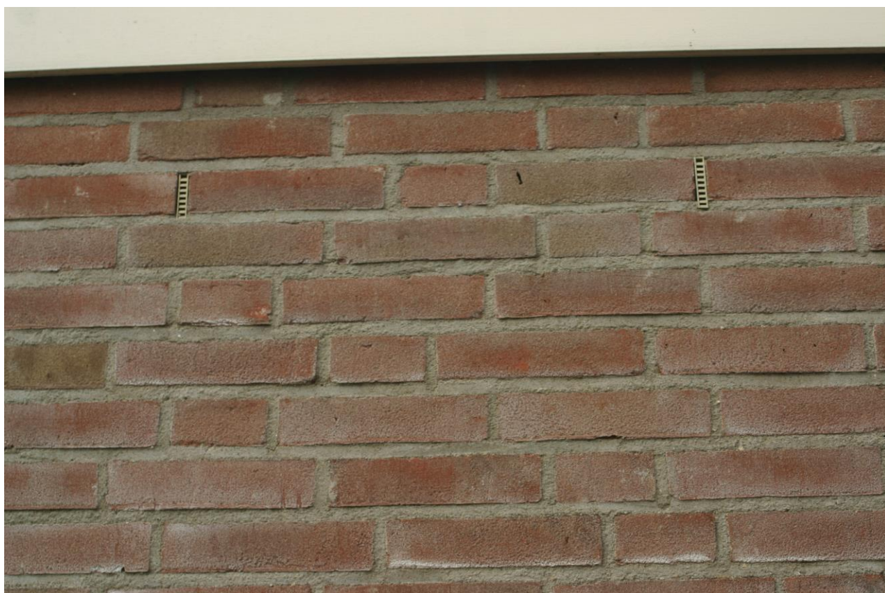
Figuur 4.5.2. Van rooster voorziene open stootvoeg van het woonhuis op nr. 26.
