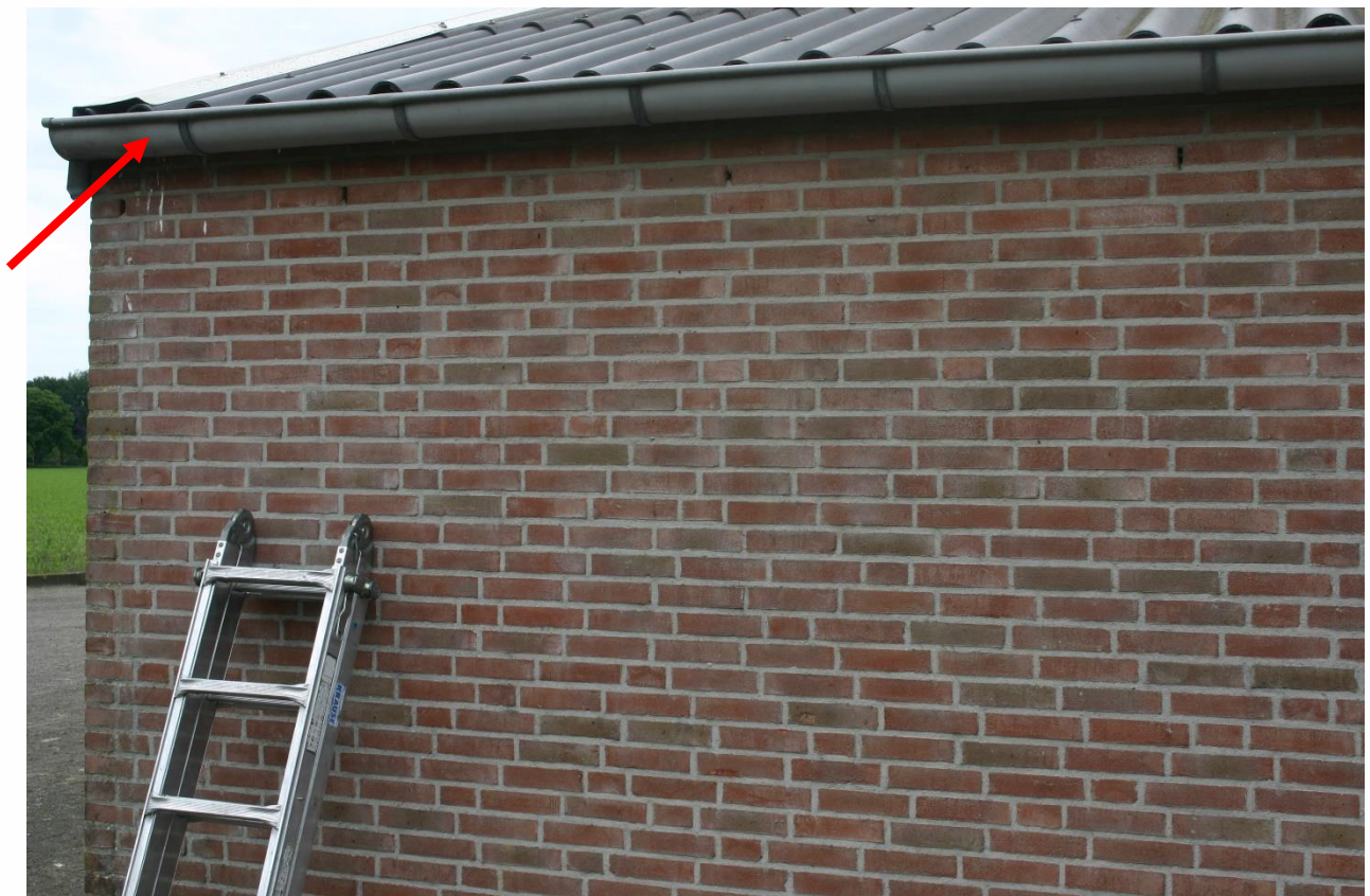
Figuur 4.4.3. In varkensstal 5 (deelgebied 1) is een spreekwennest aanwezig (zie rode pijl). Ook de uitwerpselen tegen de onderliggende gevel duiden op een vogelnest.
