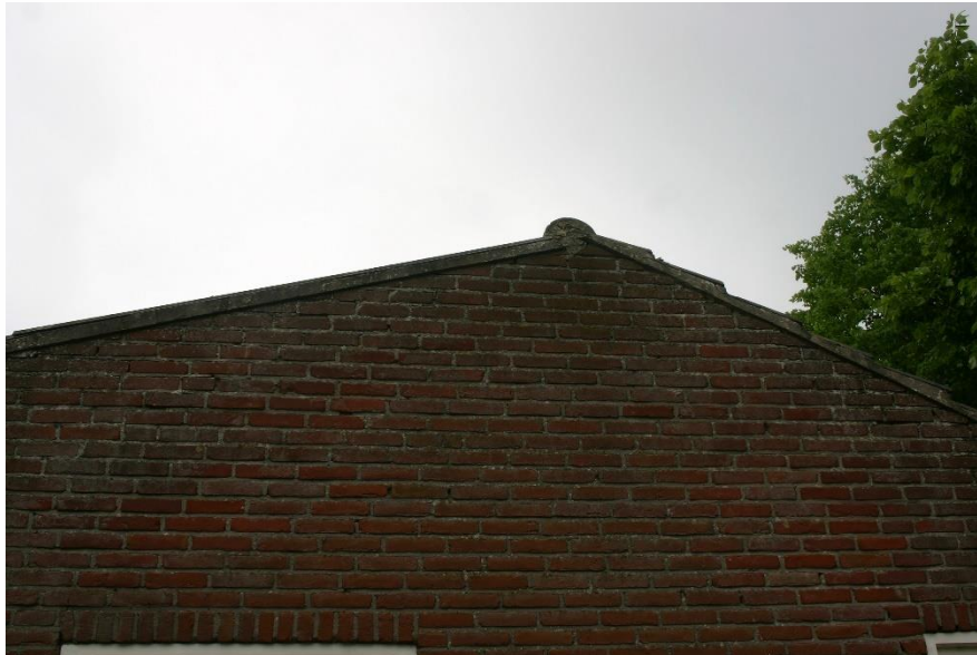
Figuur 4.4.6. Aan de kopzijde van de aangebouwde garage (3 in figuur 3.1.11) kunnen geen vleermuizen of vogels het dak in.
