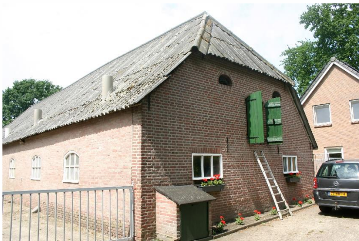
Figuur 4.1.20. Gebouw 2 (in figuur 4.1.18) heeft een cementhoudend golfplaten dak.
