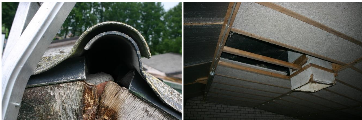
Figuur 4.4.7. De meeste daknokken (links) en alle vlieringen (rechts) en zolders zijn tijdens het veldbezoek met behulp van ladder, RIDGID Seesnake en zaklamp geïnspecteerd.
