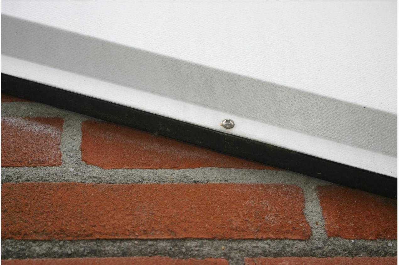
Figuur 4.4.2. De kopsen kanten van de stallen in deelgebied 1 zijn niet toegankelijk voor vleermuizen of vogels.
