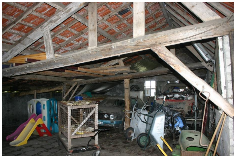
Figuur 4.4.3. De wanden en het dak van schuur B zijn volledig enkelwandig.
