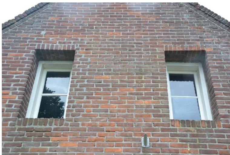
Vensters op de verdieping. Aan het inboetwerk links is te zien dat dit venster later is ingemetseld.
