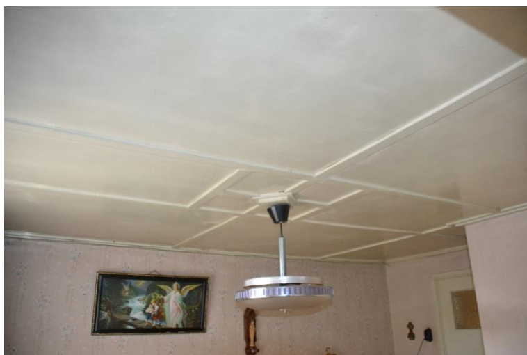
Zachtboardplafond in slaapkamer.
