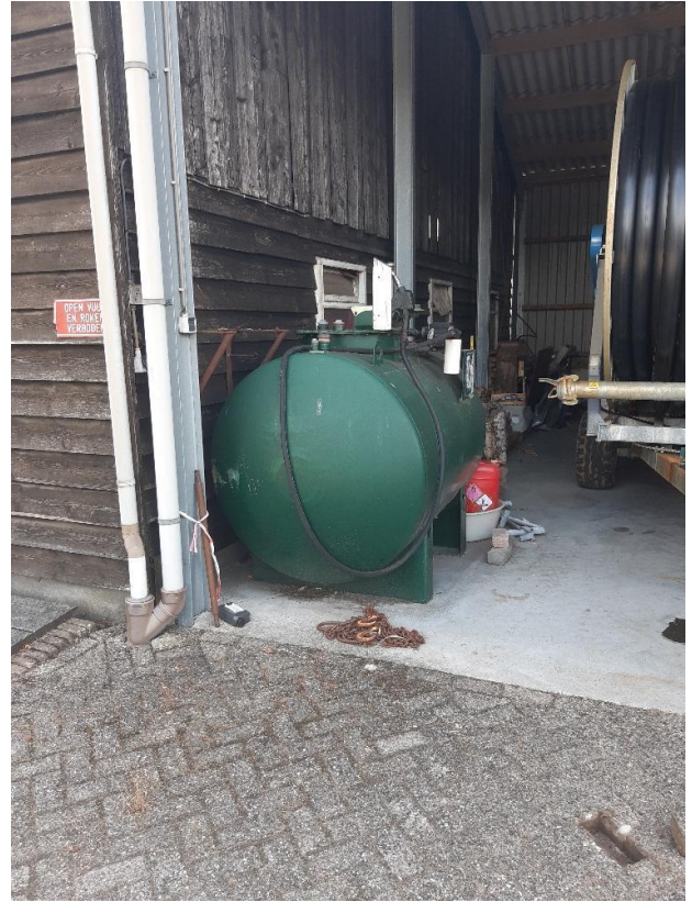
Foto 5: Aanwezige bovengrondse dieseltank (1.500 liter) (boringen 101, 102 en 103)
