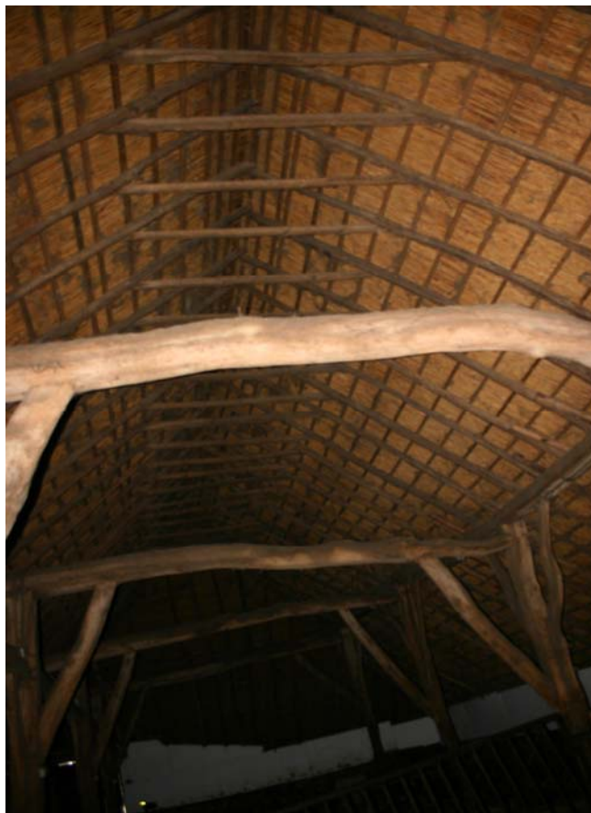
Afbeelding 6. De rieten dakbedekking drukt overal tegen de balken aan.
