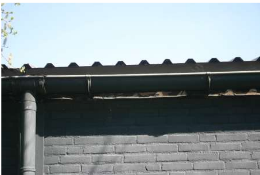
Figuur 4.4.3. Er is geen ruimte in en onder het sandwichpanelen dak.
