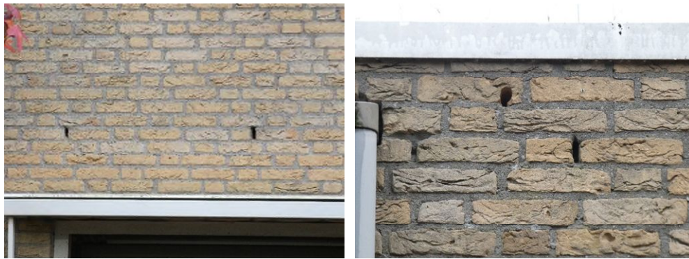
Figuur 4.3. Open stootvoegen in kazernehuis en bijgebouw.
