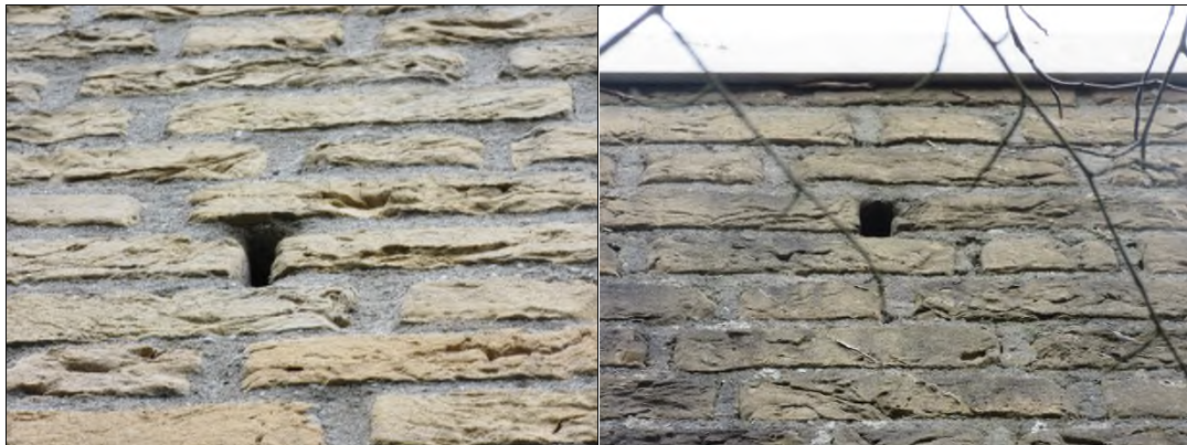
Figuur 5.5. Impressie spouwmuurgaten.
