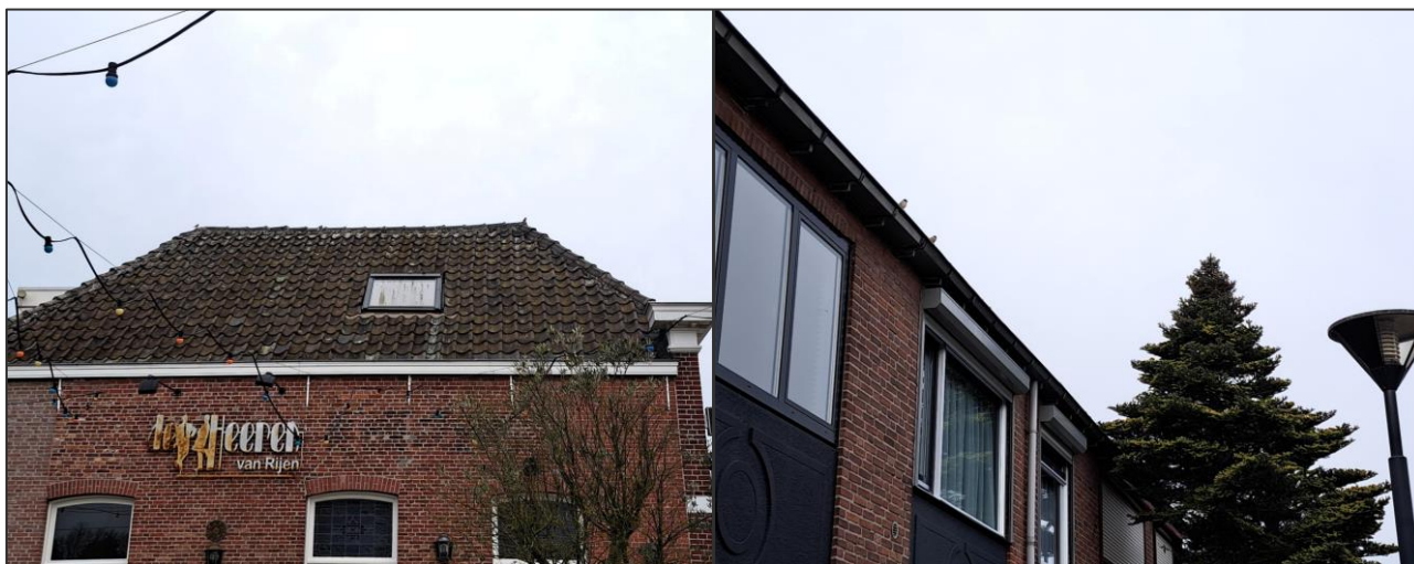
Afbeelding 3.1 Huismussen onder dakpannen gebouw Stationsstraat 1 (links) en huismussen onder dakpannen bij Spoorlaan Zuid 27A+B.
