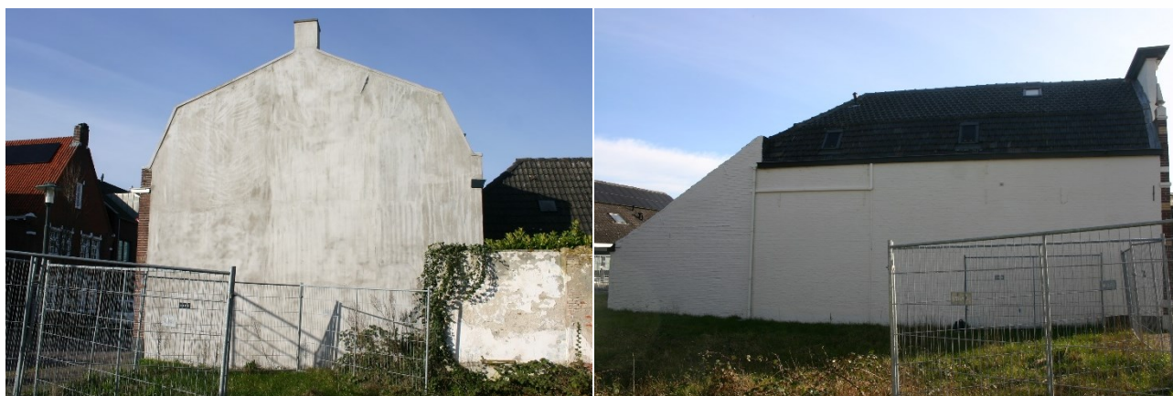
Figuur 4.4.1. Open stootvoegen zijn afwezig en de ruimtes onder de dakpannen zijn niet bereikbaar door een verhoogde gevel (l) en een aansluitende dakgoot/pannen in de specie (r).
