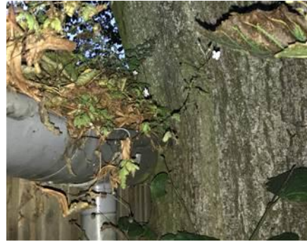
Afbeelding 9: boom 30 overgroeid dakgoot
