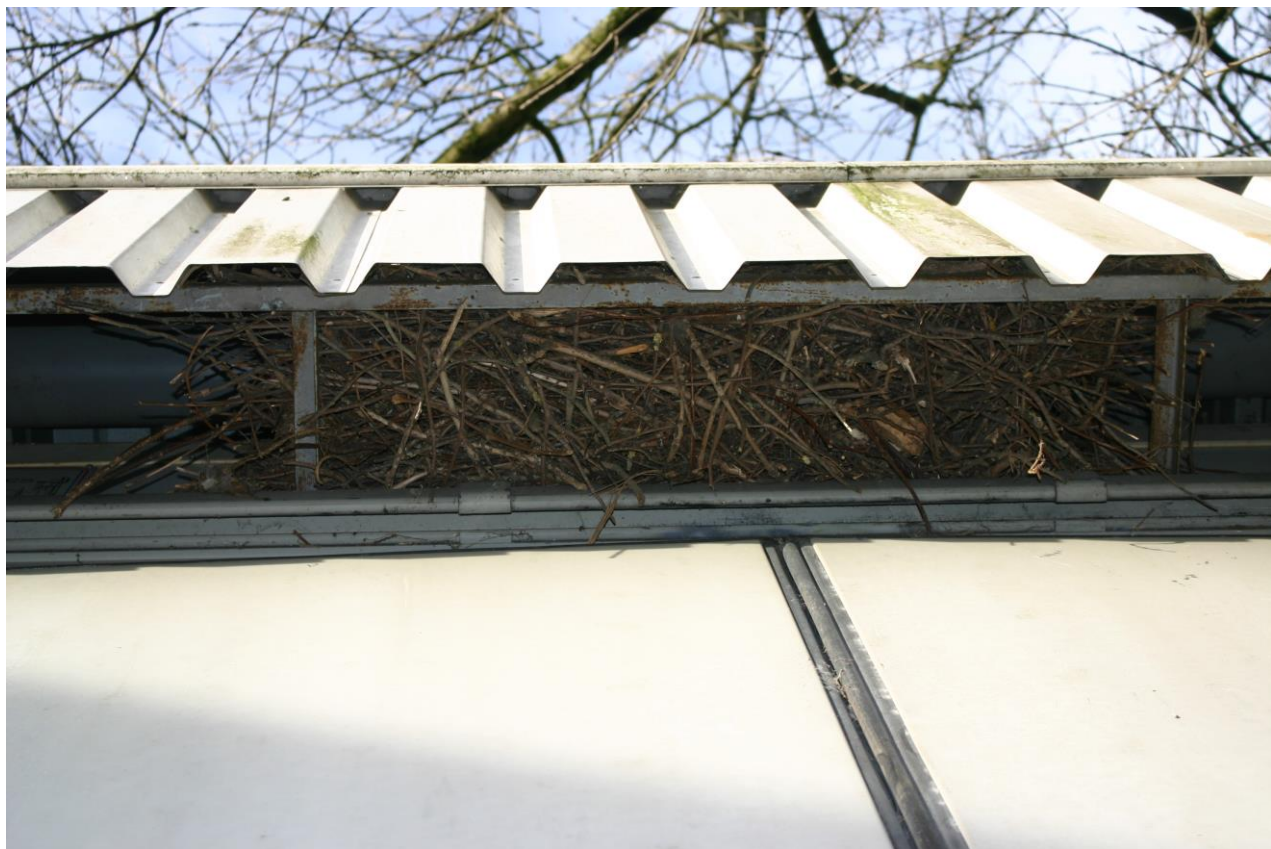
Figuur 4.5.1. Aan de buitenzijden van een damwand gebouw bevindt zich een oud duivennest.
