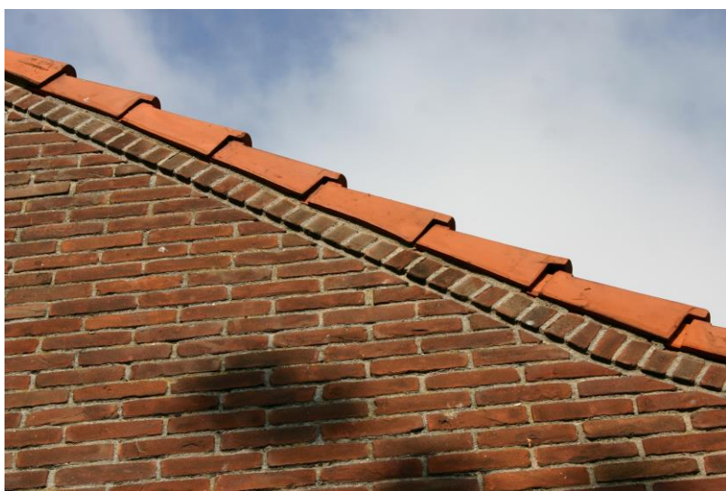
Figuur 4.2.2. De gevelpannen op het woonhuis zijn met een laag specie afgewerkt.
