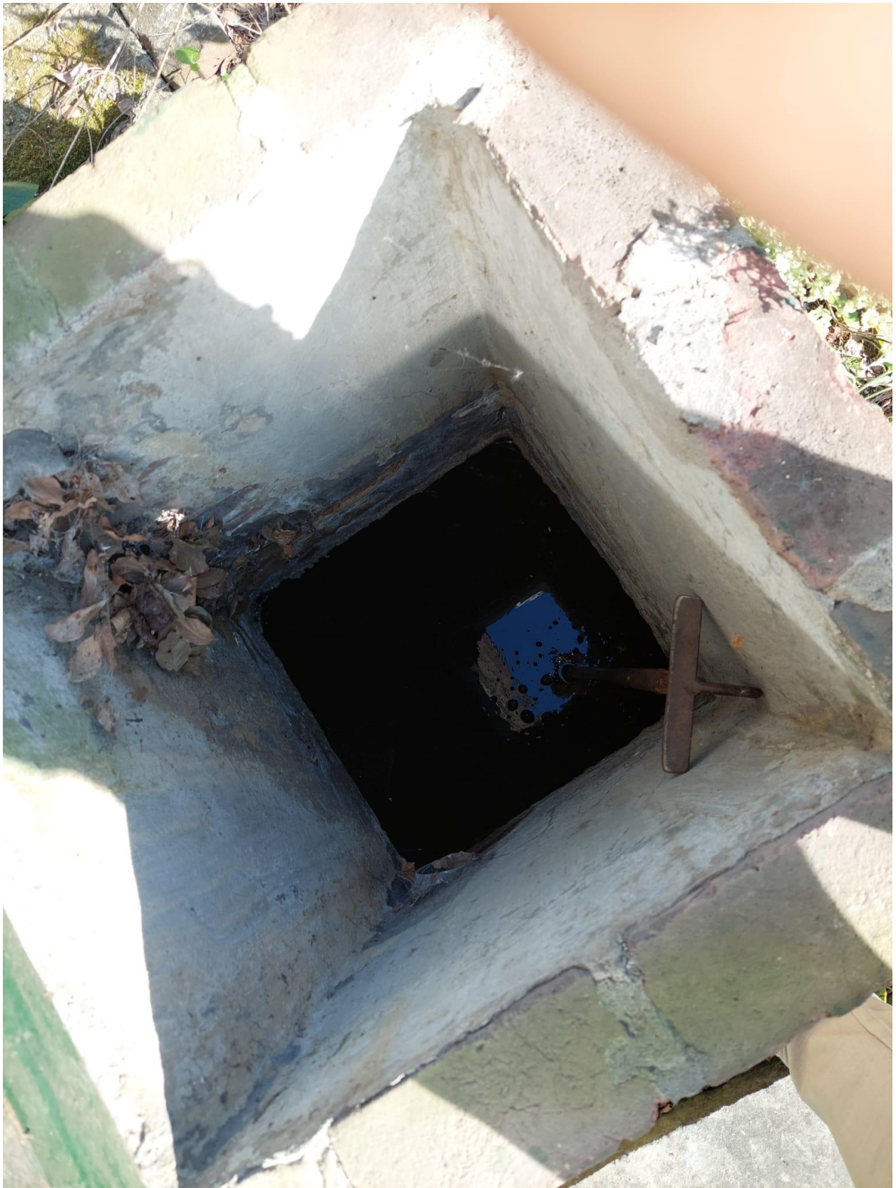
Figuur 50: Gierput is dieper gelegen dan de fundering. Dezelfde schoffel als bij de andere foto is gebruikt om de diepte te schatten. Gierput is niet aangegeven op de bouwtekening.
