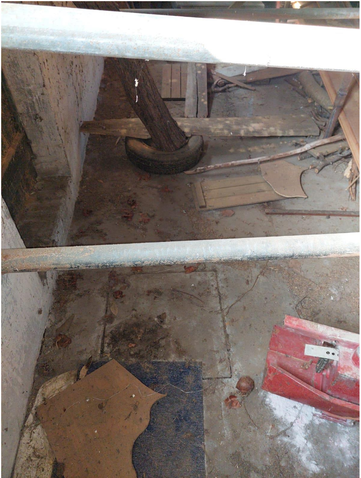
Figuur 53: Dichtgemetselde gierput.
