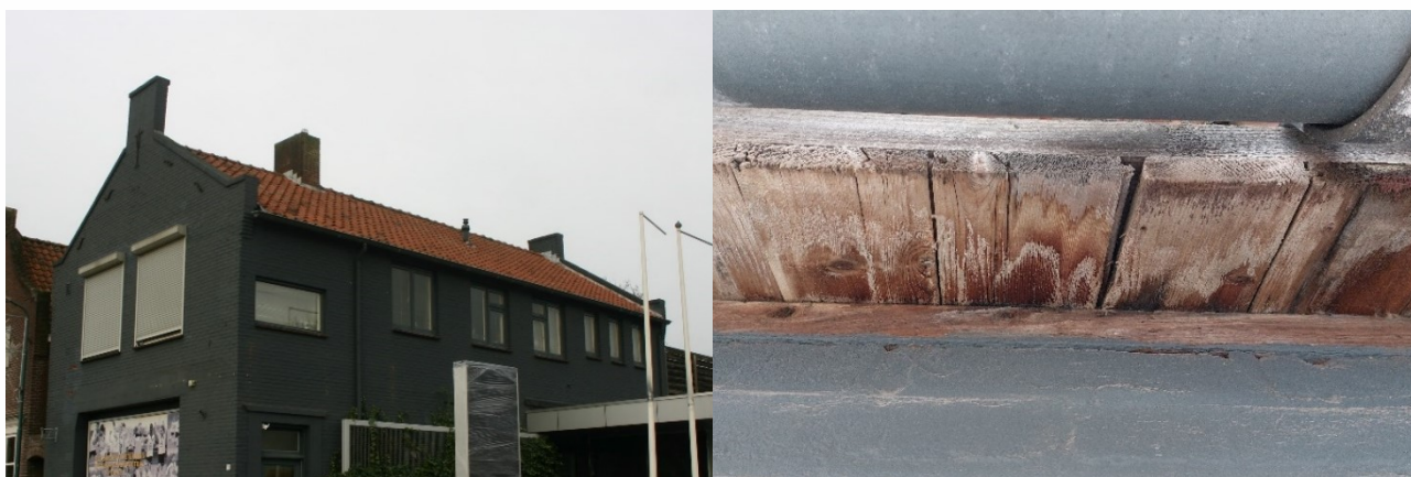
Figuur 4.4.2. Opgemetselde gevels en een overstekend dak belemmeren de toegang voor gierzwaluwen en vleermuizen.
