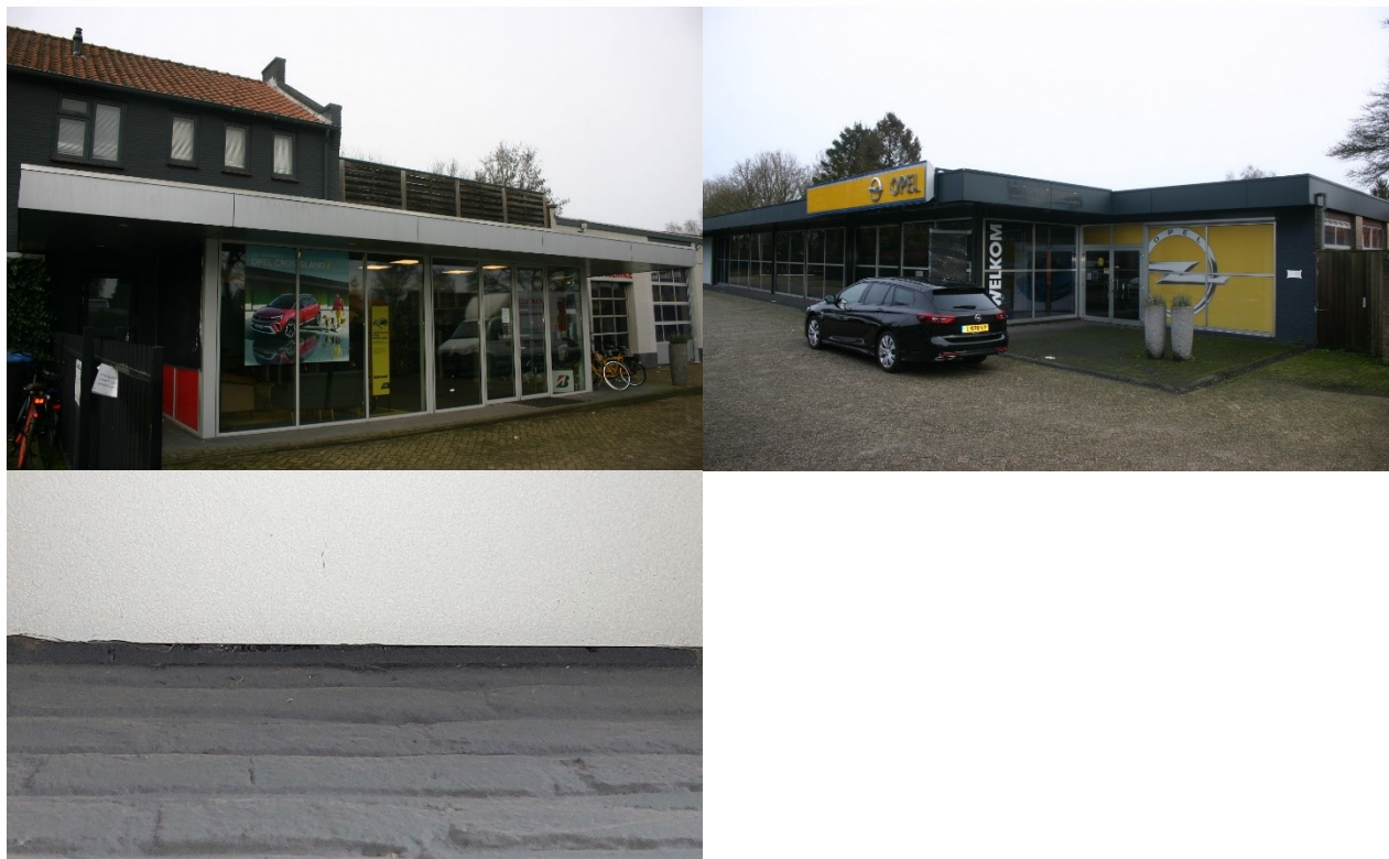
Figuur 4.4.3. De receptie (lb) en de showroom (rb) bevatten een geheel plat dak. Spleten tussen de platen onderling en de platen en gevels zijn afgedicht met compriband (lo).
