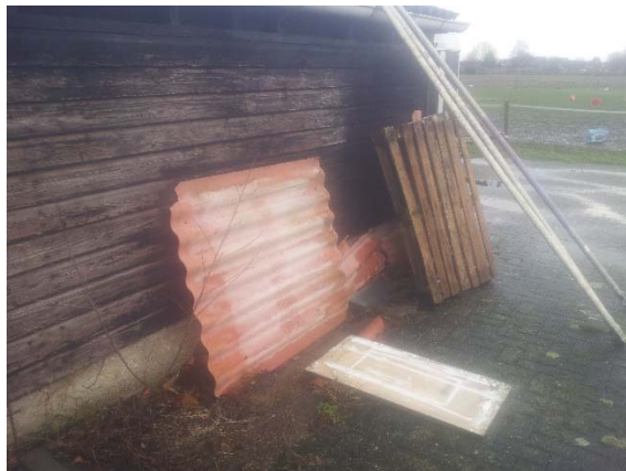
Afbeelding 4: asbestverdachte golfplaat op klinkerverharding
