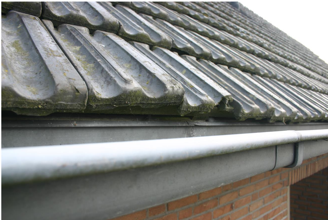
Figuur 4.4.3. Onder de onderste rij pannen op de woning is te weinig ruimte aanwezig voor vogelnesten.
