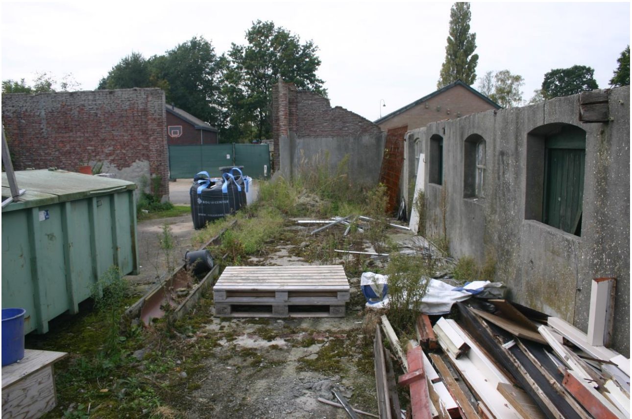
Figuur 4.1.4. Het deel van de voormalige varkensstal zonder dak.
