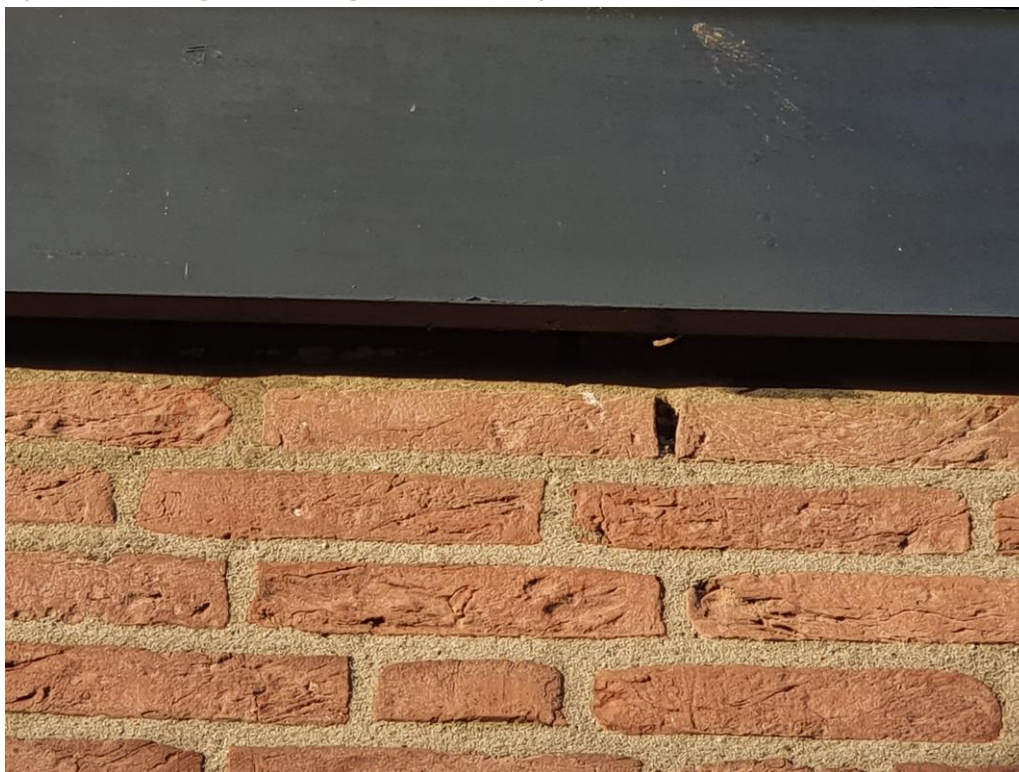
Open stootvoegen in oostgevel van het pand:
