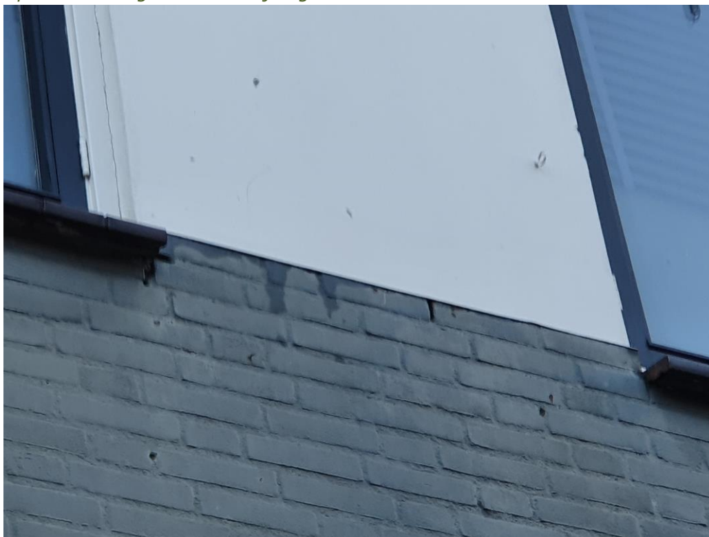
Open stootvoegen in westelijke gevel:
